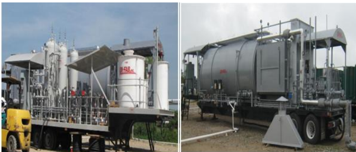
Figura 4.12 Unidad de tratamiento de agua y generador de vapor
