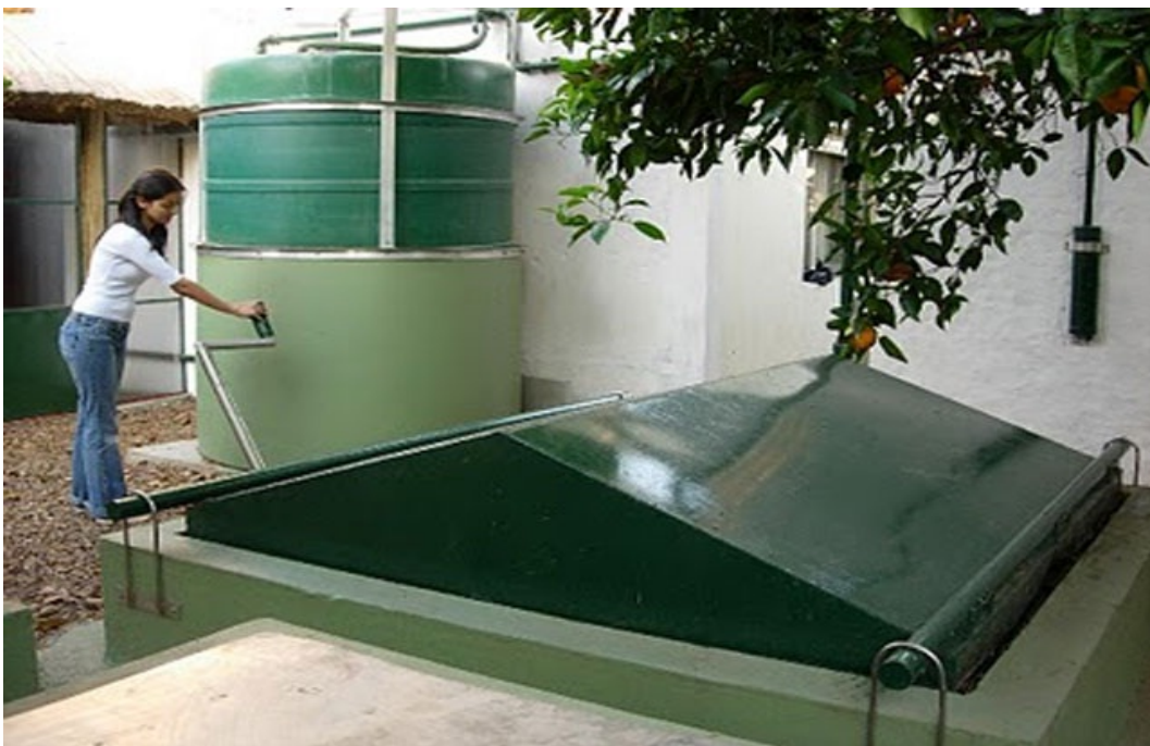
Figura 1.8: Biodigestor tipo fosa [4]
