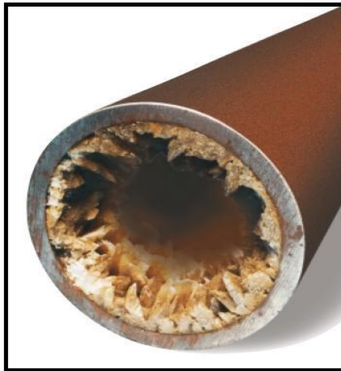
Figura 6.6. Incrustaciones de carbonato de calcio en una tubería de producción 29 .
