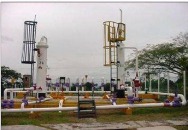
Batería de Separación Tierra Blanca
