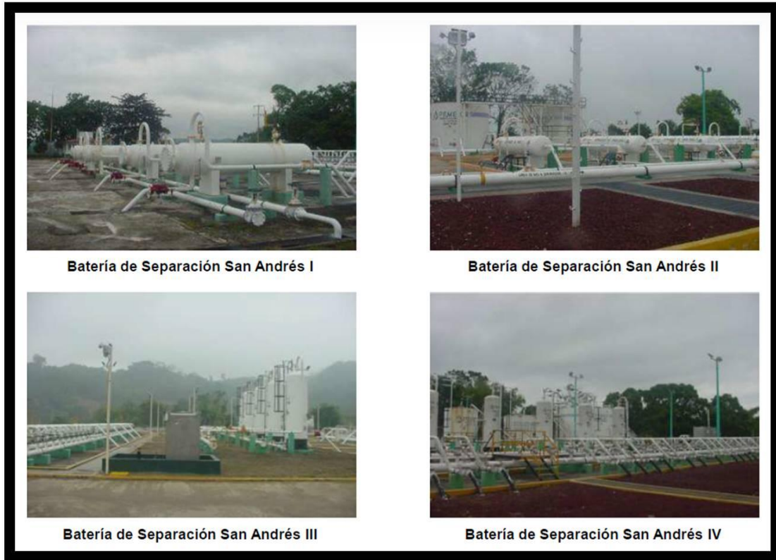
Fig. 4.20. Baterías de separación del Bloque San Andrés (Tomada de PEMEX, 2012).
