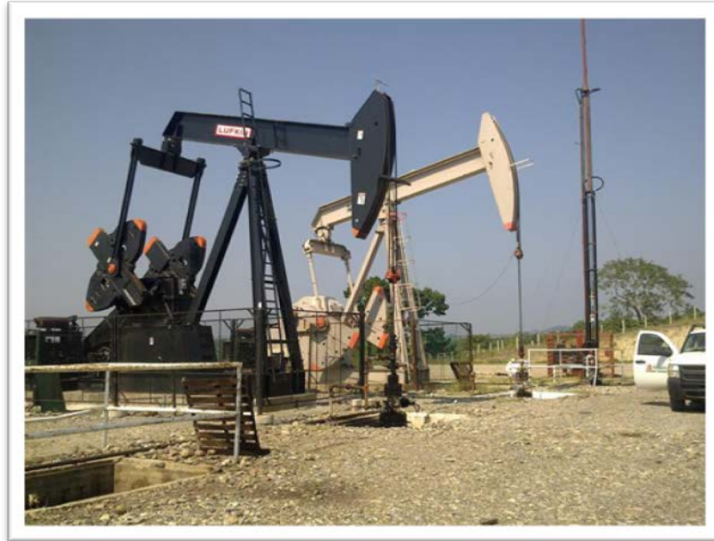
Figura II-10 Unidades superficiales de bombeo mecánico de balancín clase I.
