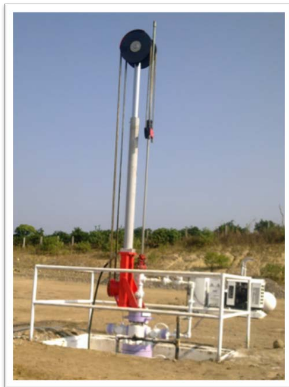
Figura II-14 Unidad Corlift de bombeo mecánico.
