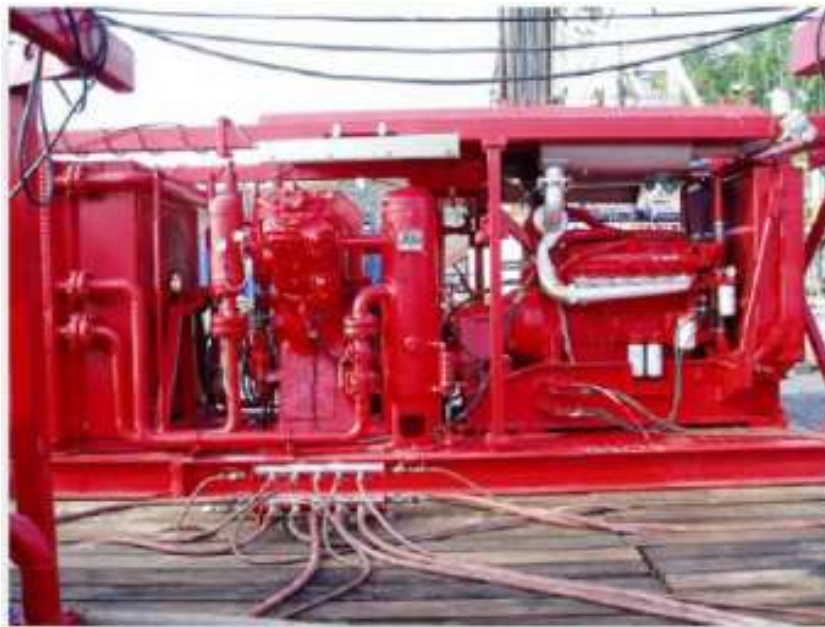
Figura 2.3 Booster Empleado en Operaciones de Perforación con Espuma
