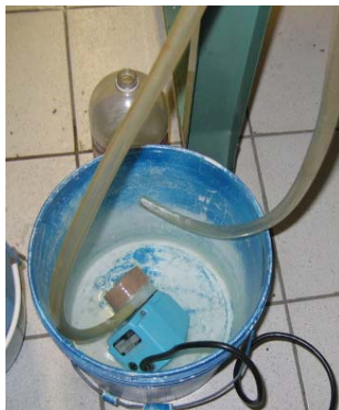
Fotografía 9.- Bomba de abastecimiento de agua
