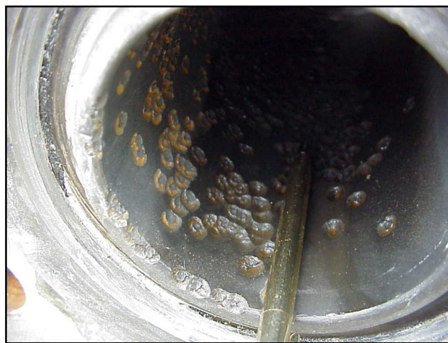
Figura 3.23 Esta corrosión, ocasionada por CO 2 , se denomina "pitting" y se presenta en todos los componentes tubulares, porta-estranguladores, conexiones superficiales, etc.
