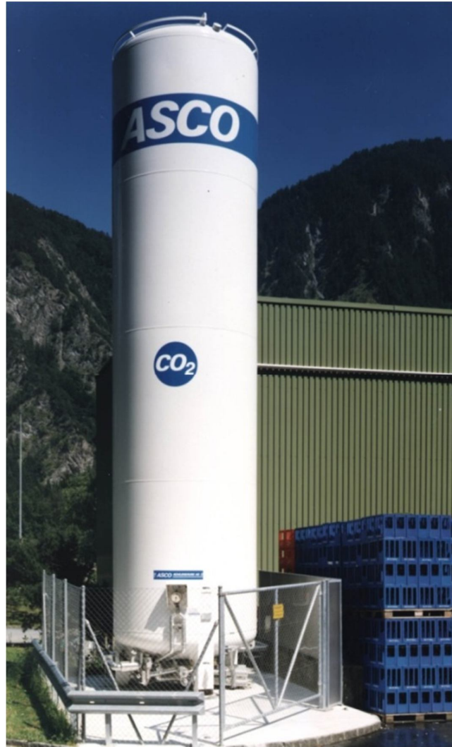
Figura 5.1 Tanque de almacenamiento de CO 2 vertical con capacidad de 37 ton, P máx = 22.43 km/cm 2
