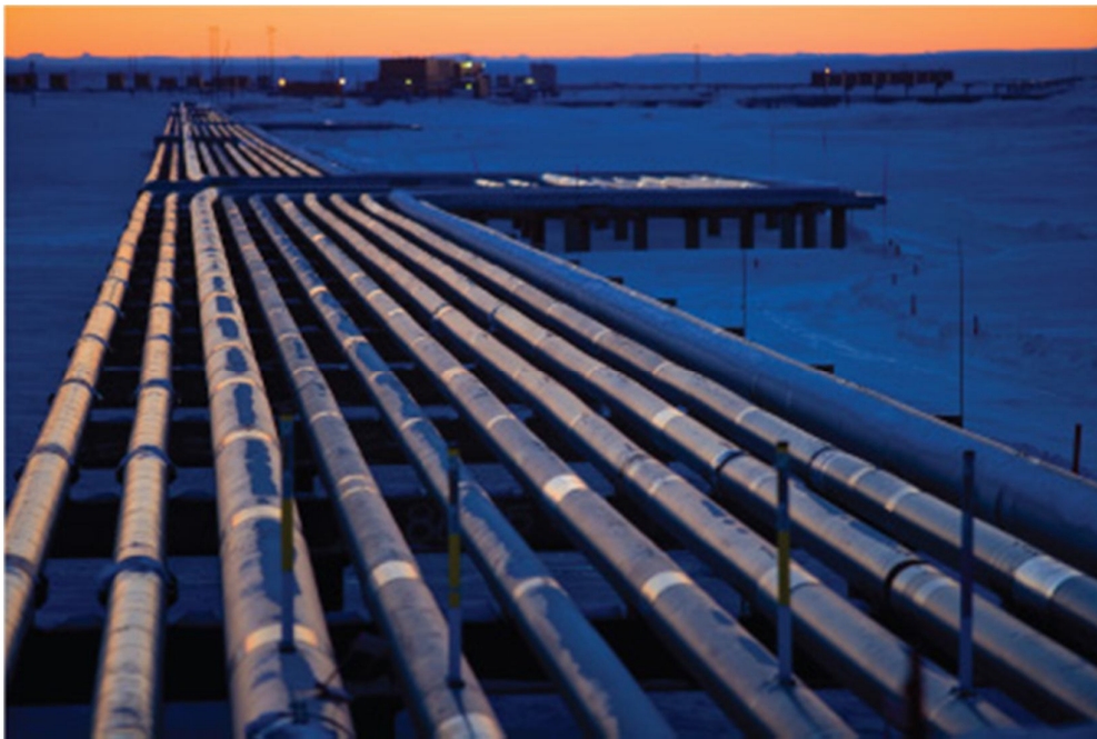
Figura 2.3 Red de tuberías de CO 2
