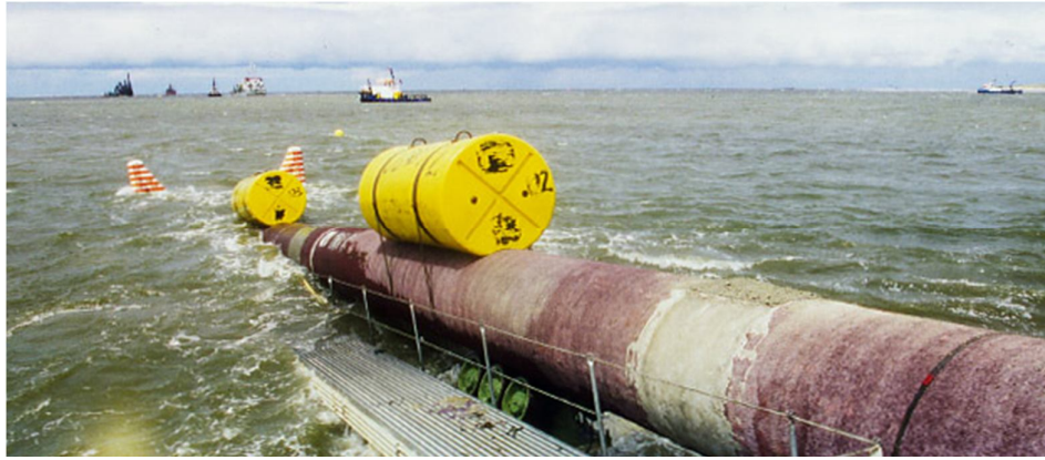
Figura 3.14 Gasoducto construido por Statoil en 2 años para Bohlen & Doyen GmbH con una inversión de 75 millones de dólares.
