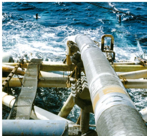
Figura 3.12 Tendido del gasoducto mediante el agujón, Langeled (conocida como Britpipe) tubería de gran diámetro que transporta gas natural desde Nyhamna en la costa oeste de Noruega a Inglaterra a través de la plataforma de Sleipner.
