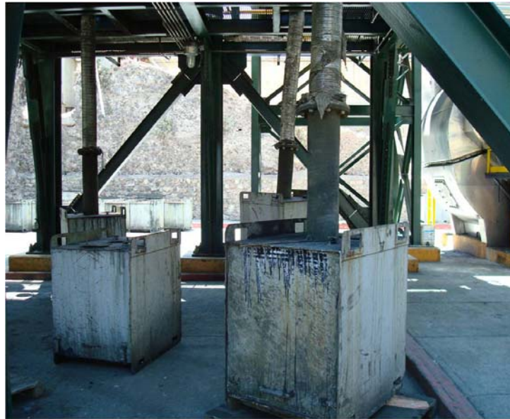
Fotografía 1. Salida de la ceniza en las tolvas de los precipitadores electrostáticos hacia los contenedores
