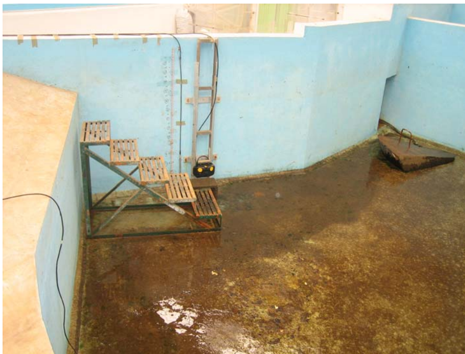
Foto 3- 1: Tanque de concreto vacío mostrando la escala lineal, transductor de presión y medidor ultrasónico
