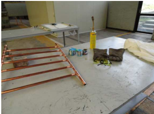
Gráfico A.3.3 Materiales y equipo de seguridad para el soldado de la tubería
