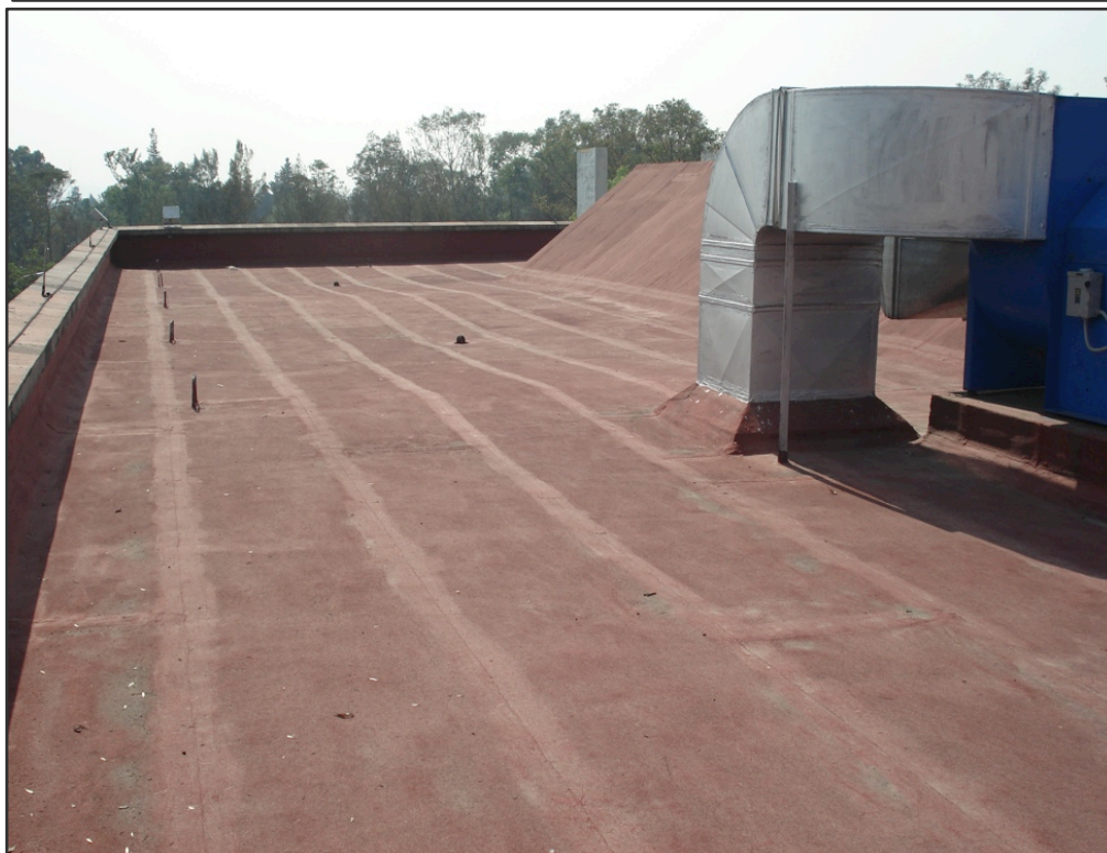
Figura 31 y 32. Tipo de impermeabilizante de la biblioteca Enrique Rivero Borrell.
