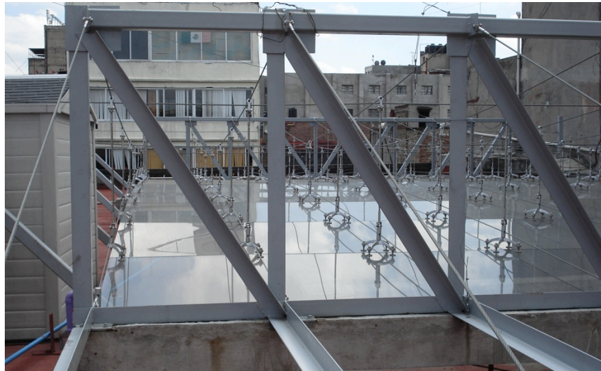
Figura 23. Superficie de captación de agua pluvial del Instituto de Ciencia y Tecnología del Distrito Federal.
