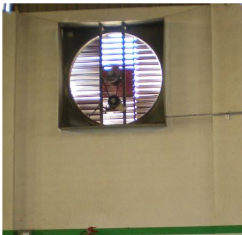
Imagen 2.4. Sistema de ventilación.
