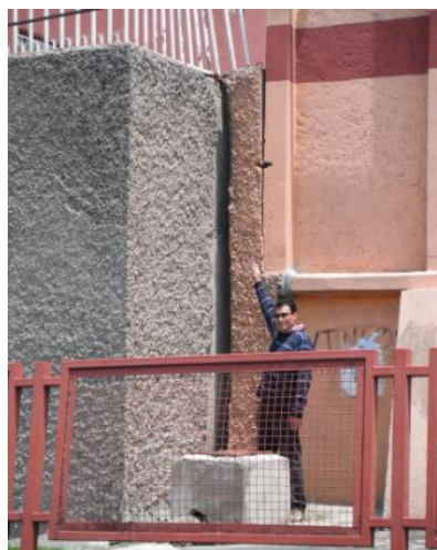
Figura 4.26 Fotografía de que muestra la separación éntrelos muros de la escuela primaria
