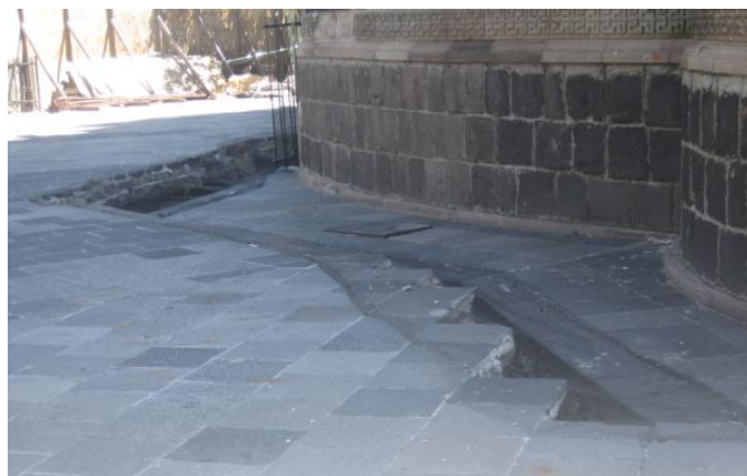
Figura 4.3 Fotografía de las fracturas alrededor de templo “El Pocito”, también se puede observar el hundimiento de la construcción.
