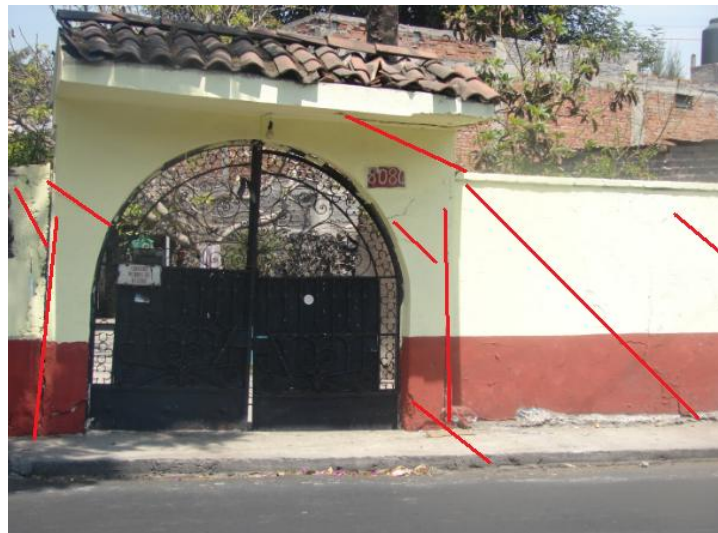
Figura 4.31 Fotografía de la fachada de una vivienda afectada por fracturamientos
