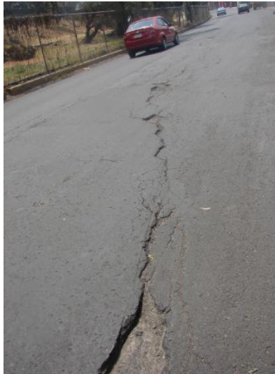
Figura 4. 30 Fotografía de la carretera México-Tulyehualco dañanda por fracturas.
