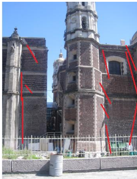
Figura 4.5 Fotografía que muestra las fracturas y separación entre cúpulas en templo de la antigua Basílica de Guadalupe.
