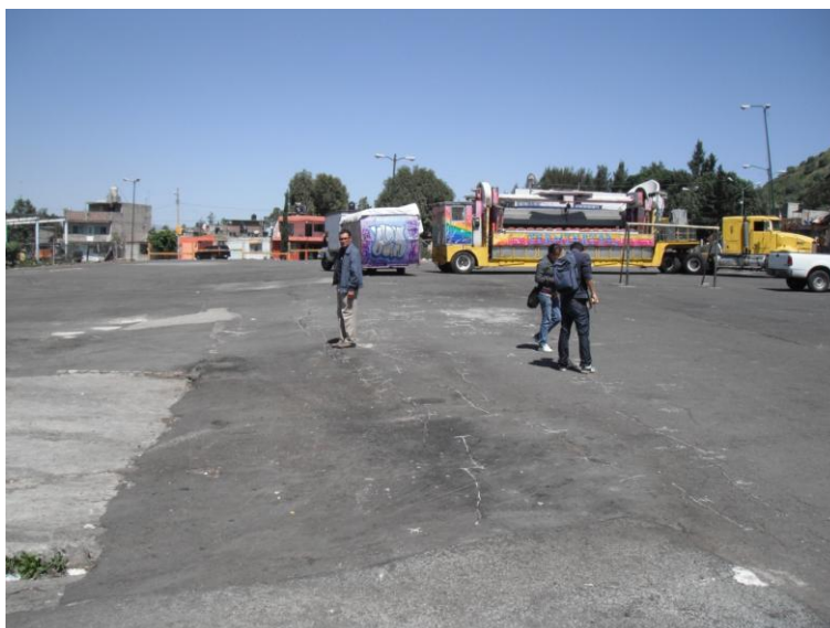
Figura 3.33 Fotografía que muestra la falla que cruza por la explanada ubicada sobre la Av. Guelatao a un costado del Peñón del Marqués. También se aprecia el reencarpentamiento asfáltico.
