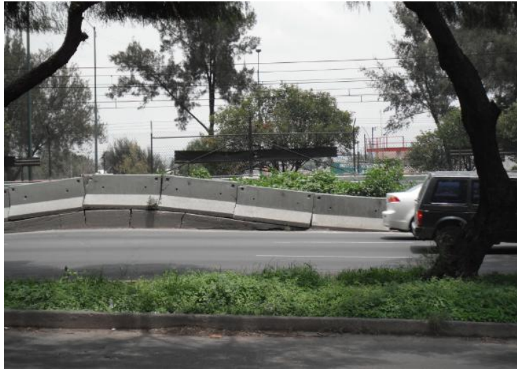
Figura 4.12 Fotografía que muestra la flexión en el muro de contención, que divide la zona de circulación vehicular del metro, en la calzada Ignacio Zaragoza.
