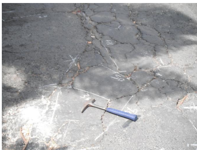
Figura 3.57 Fotografía del pavimento fracturado en la calle Emiliano Zapata.
