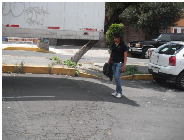
Figura 3.63 Pavimento fracturado en la calle Poniente 37, al SW del Peñón de los Baños.
