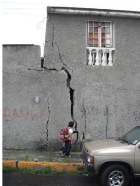
4.21 Fotografía de una construcción severamente afectada
