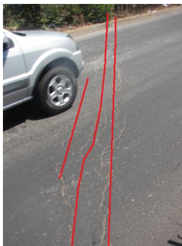
Figura 3.73 Fotografía del pavimento fracturado en la Carretera México- Tulyehualco.
