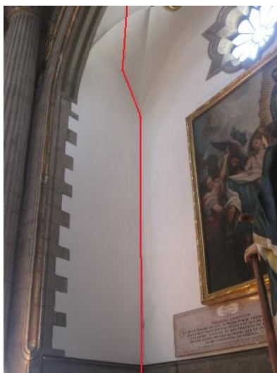
Figura 4.4 Fotografía de las fracturas que se encuentran al interior del templo “El Pocito”.
