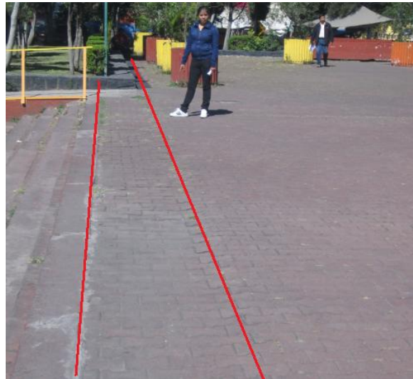
Figura 3.17 Fotografía de la explanada de la Delegación Gustavo A. Madero, afectada por fracturas.
