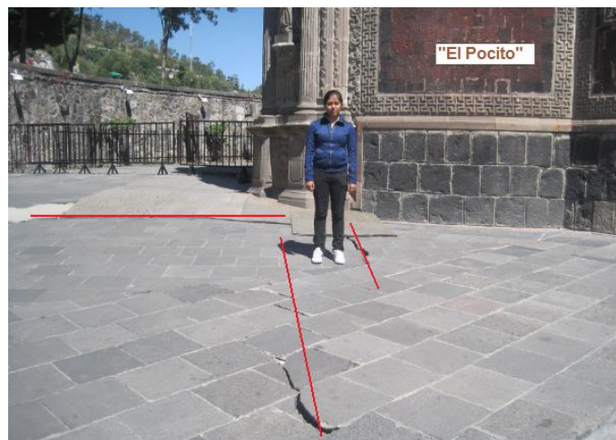
Figura 4.2 Fotografía de las diferentes familias de fracturas que se encuentran en el entorno y se extienden al templo “El Pocito”.
