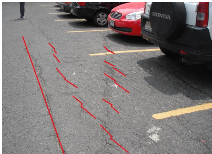
Figura 4.13 Fotografía de fracturas en echelón, en el estacionamiento para académicos de la FES Zaragoza.
