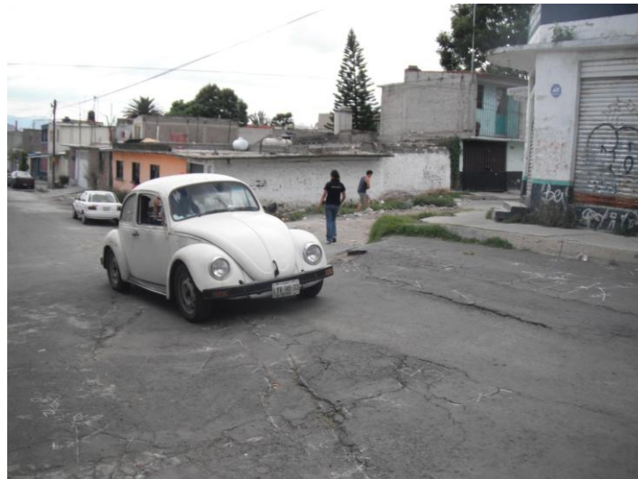
Figura 3.40 Fotografía de la calle Salvador Escalante en la que se observan los daños constructivos causado por las discontinuidades en el terreno.
