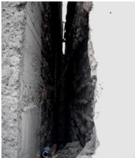
Figura 4.23 Fotografía que muestra la separación entre muros de una vivienda abandonada.
