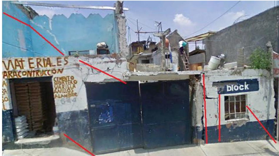
Figura 3.67 Vivienda de la calle Norte 194, afectada por el fracturas.
