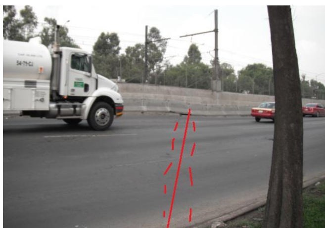
Figura 4.11 Fotografía de los fallamientos y fracturamientos sobre la Av. Zaragoza en las inmediaciones del Peñón del Marqués.
