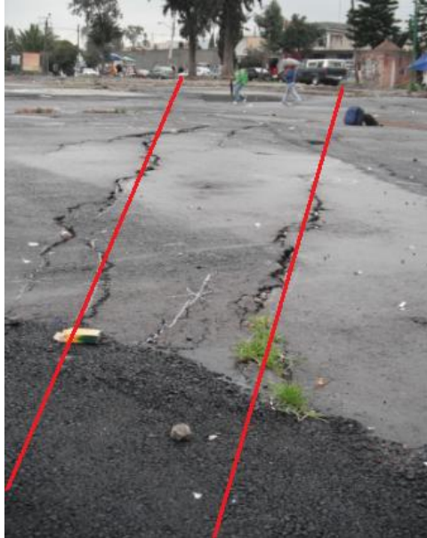
Figura 4.20 Fotografía del sistema paralelo de fracturas visible en la explanada del pueblo de San Juan Ixtayopan.
