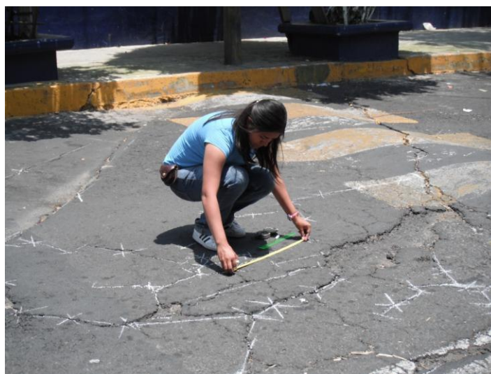
Figura 3.60 Pavimento fracturado en la calle Matamoros.
