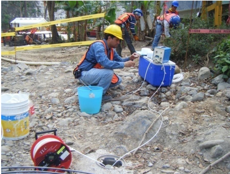
Foto 4.2. Muestra el procedimiento para tomar la muestra de agua subterránea en los sondeos
