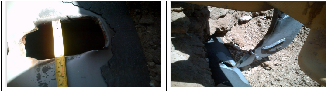
Figura 5.41 Fotografías de gasoducto de 16" de DN perforado por máquina excavadora
