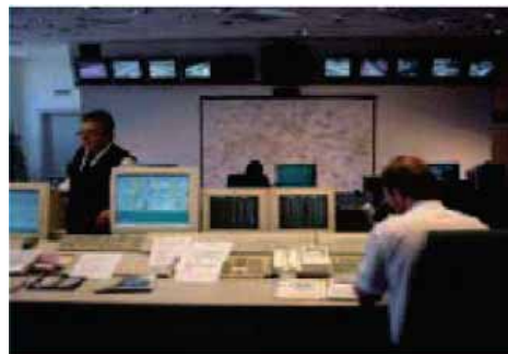
Imagen 3.2: Centro de control de tráfico
