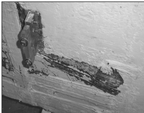
Fig. 8.2. Falla por adherencia del CFRP, Tensor horizontal principal
