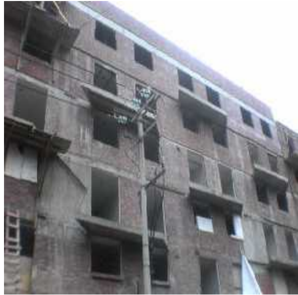
Figura 3.17 construcción de departamentos sin respetar las distancias mínimas entre línea de media tensión y la construcción
