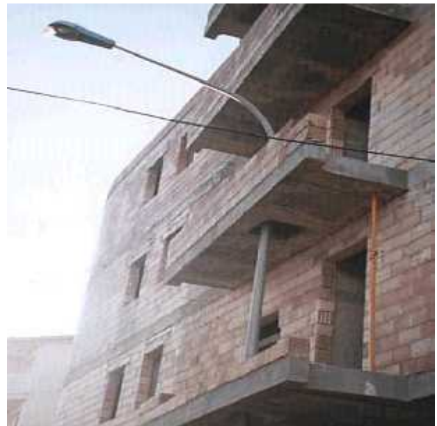
Figura 3.19 construcción realizada sin retirar el poste de alumbrado público
