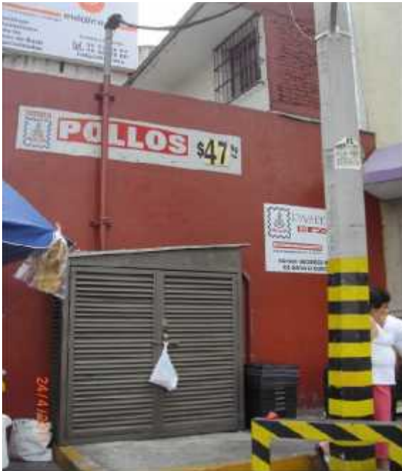
Figura 4.7 Foto tomada de acometida aérea a murete
