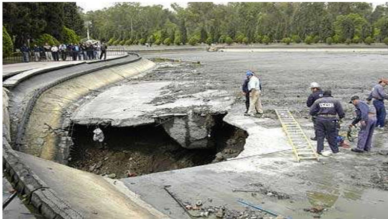
Figura 1. Grieta en el Lago Mayor del Bosque de Chapultepec
