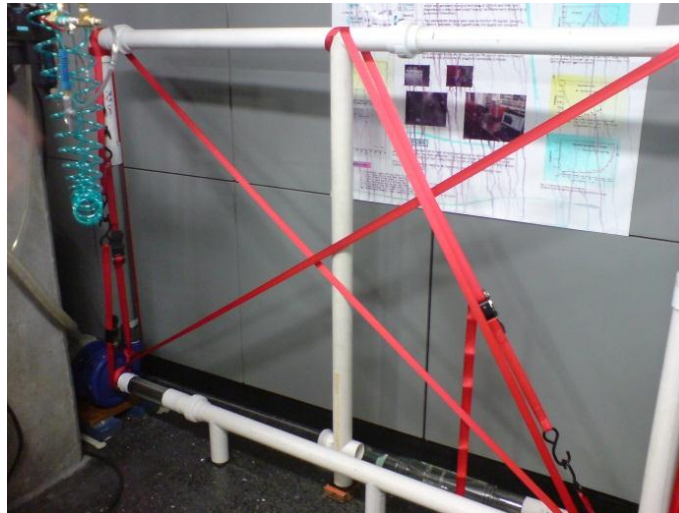
Figura 31. Circuito hidráulico bomba 5 HP, donde se muestra el arreglo de los tensores para reducir las vibraciones presentes en el sistema.
