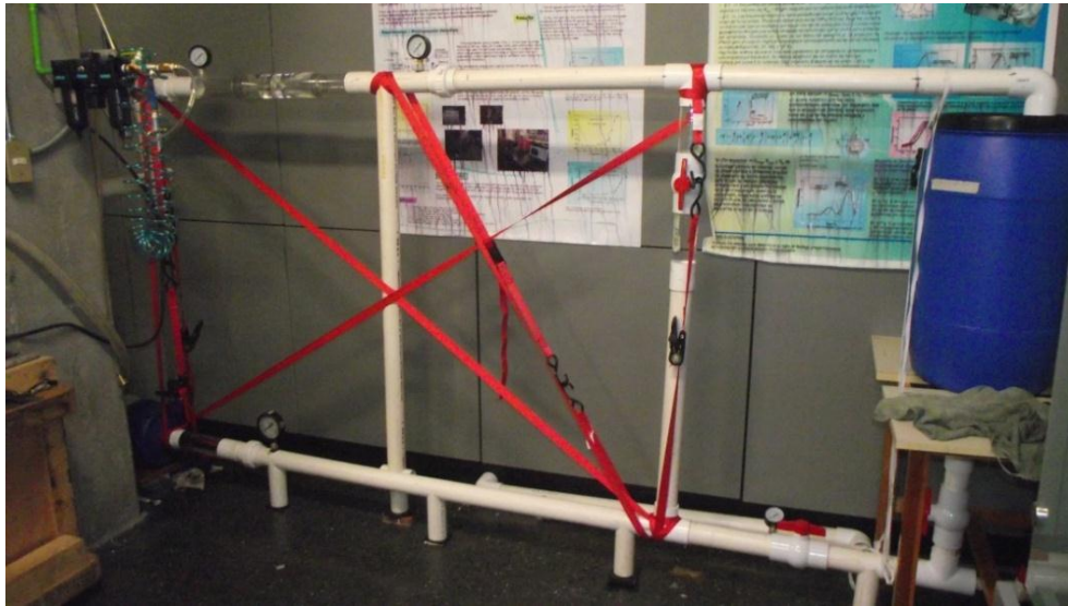
Figura 33. Circuito hidráulico de la bomba de 5 HP con tubo Venturi y manómetros instalados.
