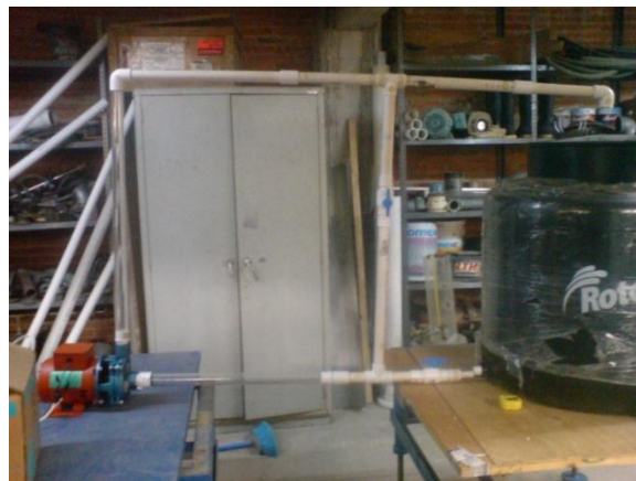
Figura 11. Primer circuito hidráulico desarrollado físicamente para la producción de cavitación.
