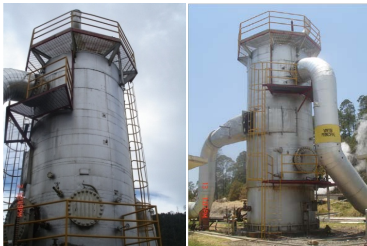
Figura 2. Separador de vapor de la Unidad 7.
