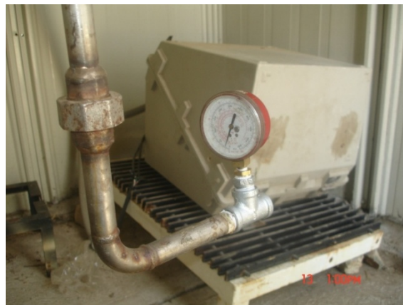
Figura 5. Montaje del manómetro. Fotografía del 13 de mayo del 2011.
