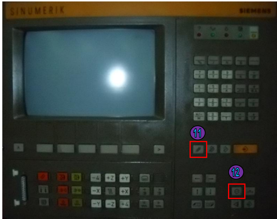
Fig. 3.5.4 Desactivación de alarmas.
