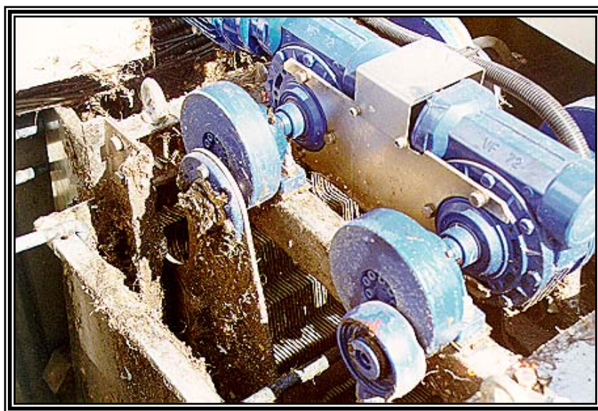
Figura 3.2. REJILLAS PARA LA RETENCIÓN DE SÓLIDOS
