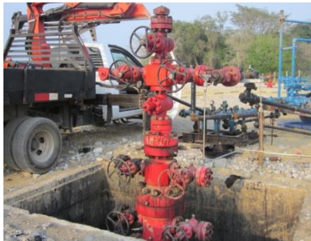
Fig. 4.7 Árbol de válvulas del pozo Humapa 1604
