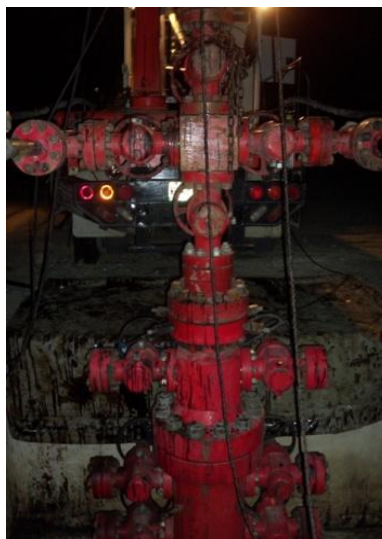
Fig. 4.10 Árbol de válvulas del pozo Humapa 1621
