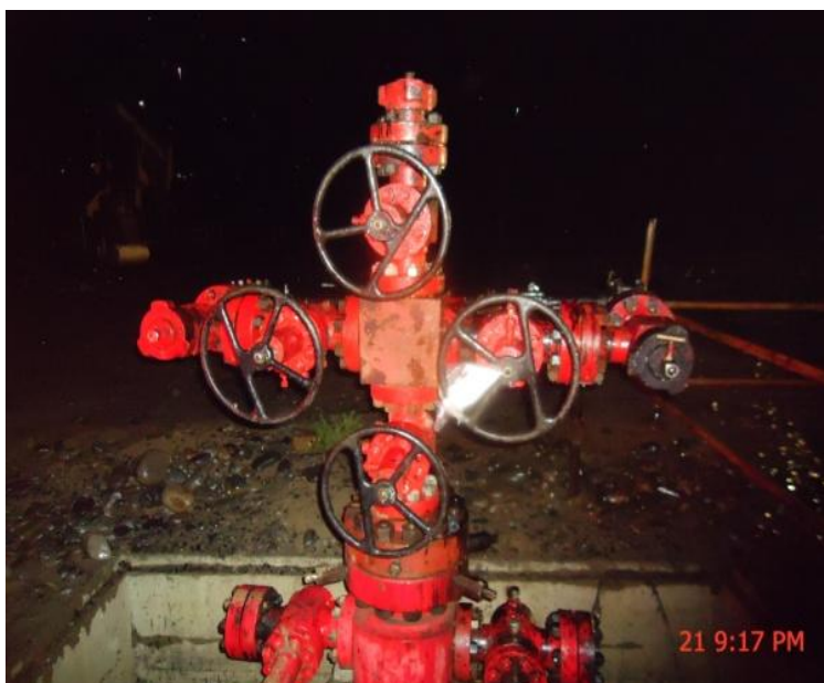
Fig. 4.4 Árbol de válvulas del pozo Humapa 1601
