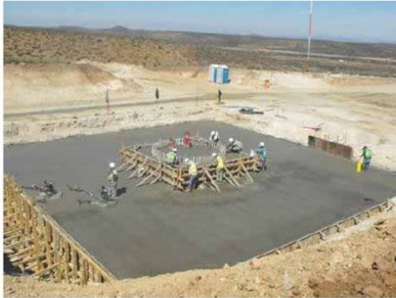
Figura 3.28 Cimentación de un parque eólico con aerogeneradores de 2 MW. Fuente. Gobierno Estatal De Baja California.
