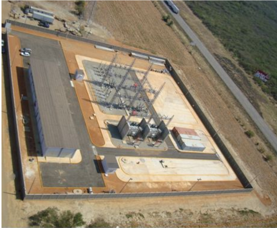
Figura 3.20 Subestación de parque eólico. Fuente. ELECTRICA DEL VALLE DE MEXICO.
