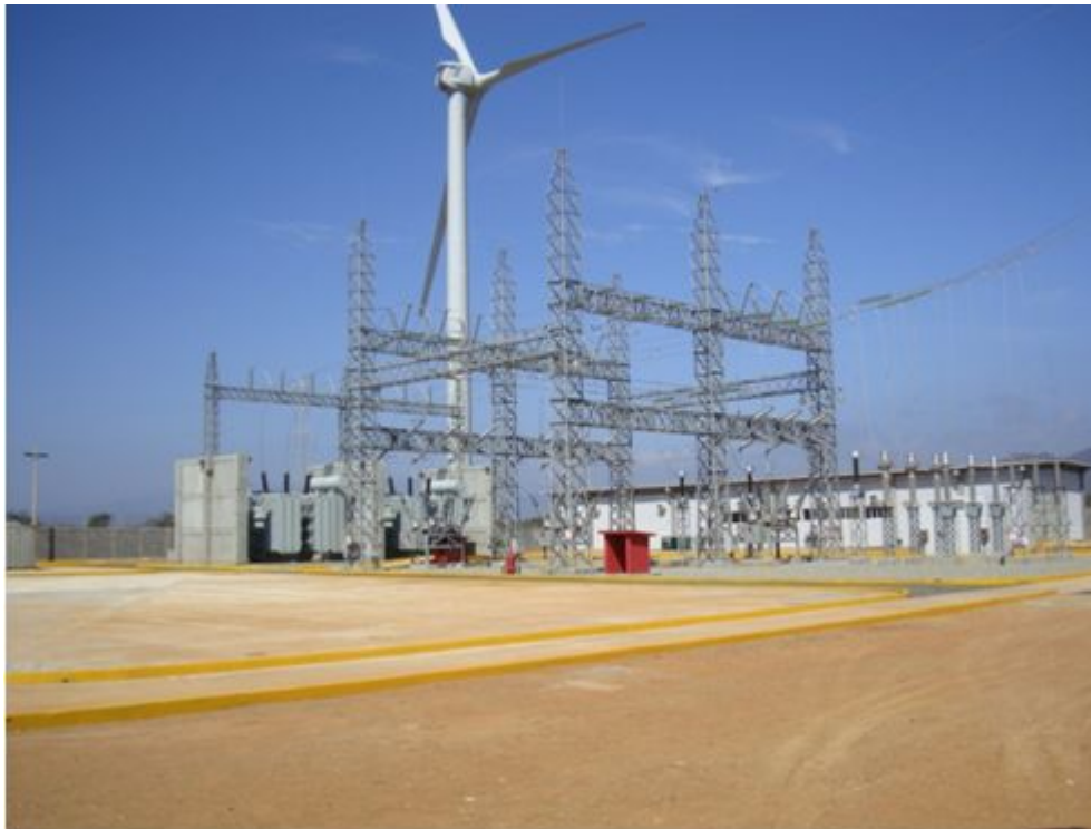
Figura 3.21 Subestación de parque eólico. Fuente. ELECTRICA DEL VALLE DE MEXICO
