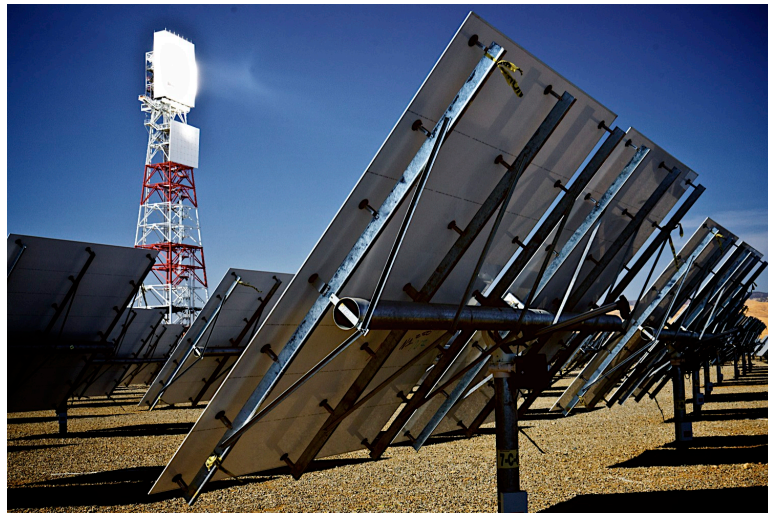
FIGURA 1 - 5 PLANTA SOLAR CON SISTEMA DE SEGUIMIENTO (HELIÓSTATOS)
