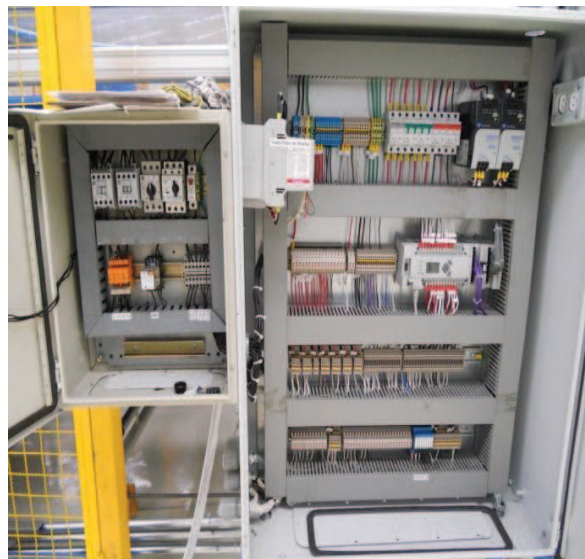
IMAGEN 4 GABINETES DE CONTROL Y POTENCIA DE LA LINEA
