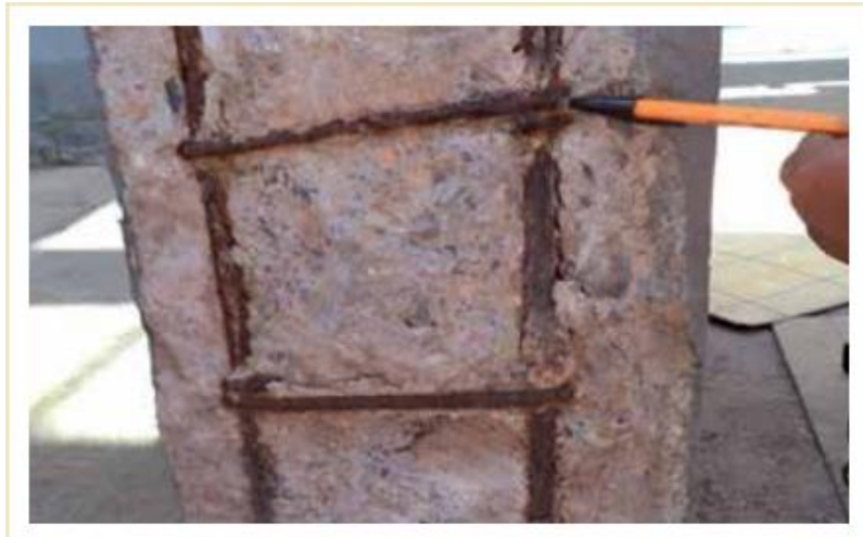
Figura 2.1. En la imagen se señala la herrumbre formada en las barras de acero reforzado en la columna de concreto armado
