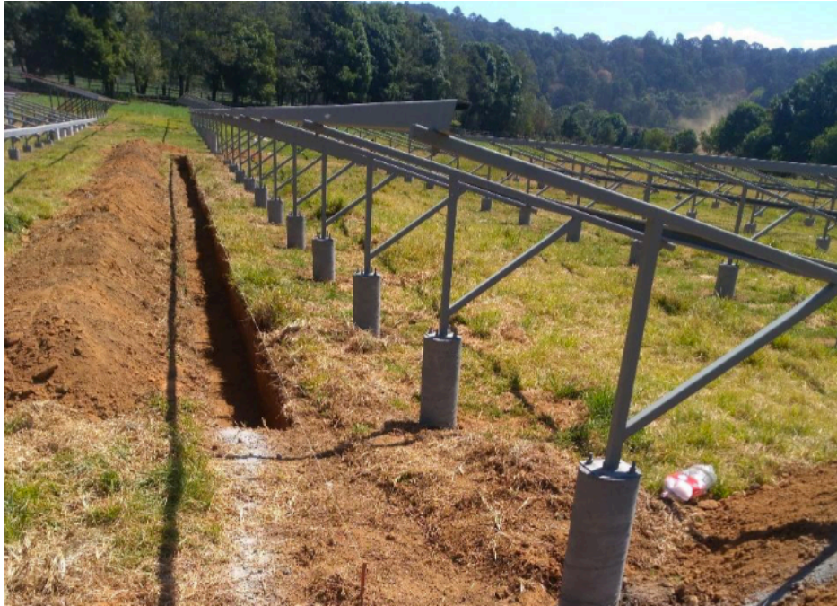
Imagen C.40. Trazo y excavación de las zanjas para las canalizaciones tanto de corriente directa como de corriente alterna.
