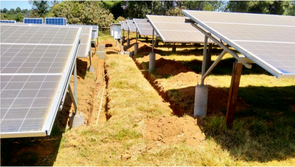
Imagen C. 43. Canalización, cableado y tubería.
