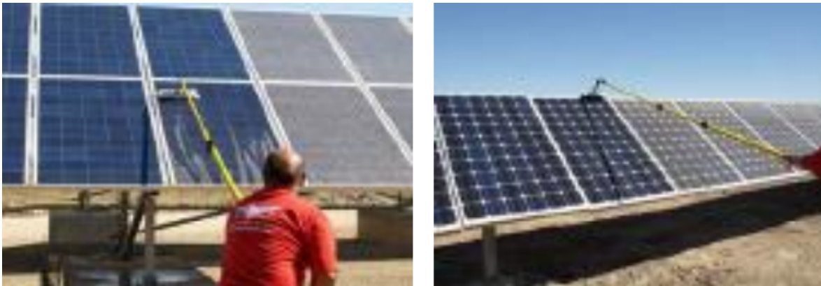
Imagen C. 48. Limpieza de una instalación fotovoltaica en pequeña escala con pértigas.
