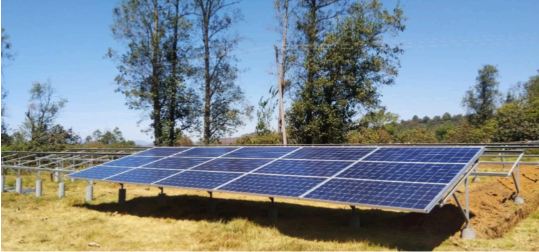
Imagen C. 42. Acomodo de los módulos solares.
