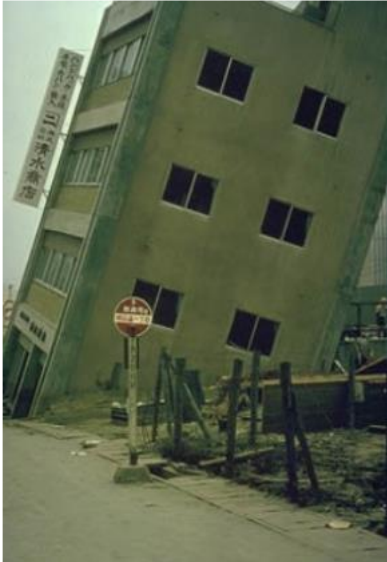
Figura 1.13. Asentamiento en edificio, sismo de Niigata, 1964.
