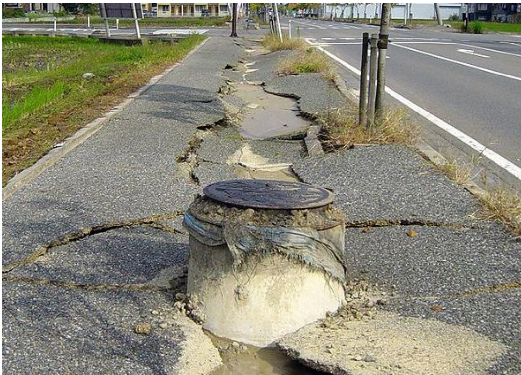
Figura 1.15. Asentamiento del terreno y emersión de estructuras enterradas, sismo de Niigata, 2004.
