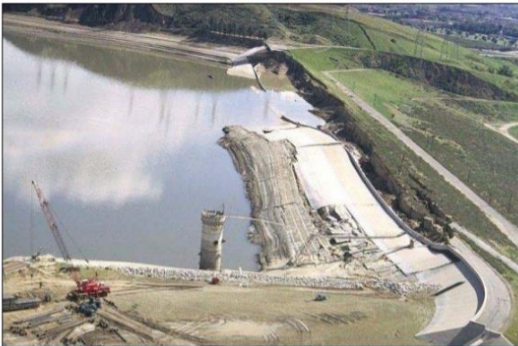
Figura 1.5. Deslizamiento por flujo de la presa San Fernando, sismo del 9 de febrero de 1971.
