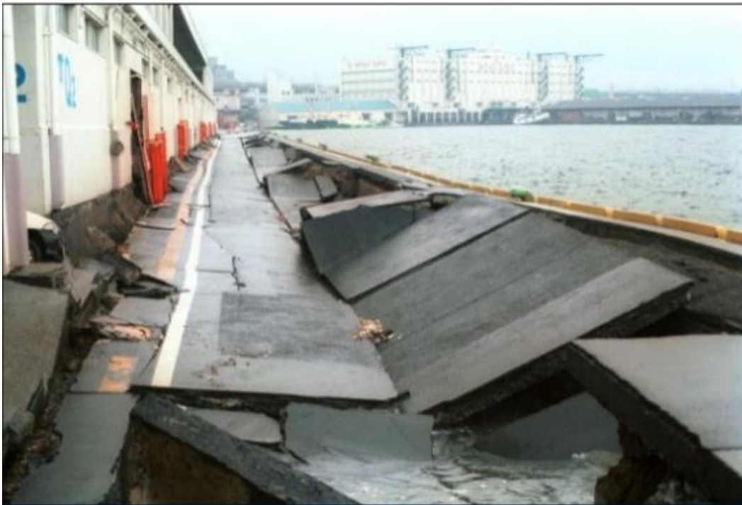
Figura 1.9. Deslizamiento lateral de muro de retención, sismo de Kobe, 1995. El muro se movió hacia afuera y la superficie del terreno se hundió.
