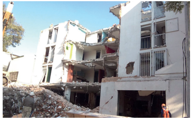
DESPRENDIMIENTO DE LA FACHADA PRINCIPAL EN ESCOCIA 29, PROCESO DE DEMOLICIÓN INICIADO.
