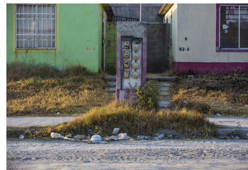
FIGURA 40: La hierba ha crecido entre los medidores eléctricos de una polvorienta calle de Huehuetoca, México, muchas casas en el desarrollo de santa teresa están abandonadas, nunca llegó el agua, corriente eléctrica por más de un año, (Brian Van Der Brug / los ángeles times).
