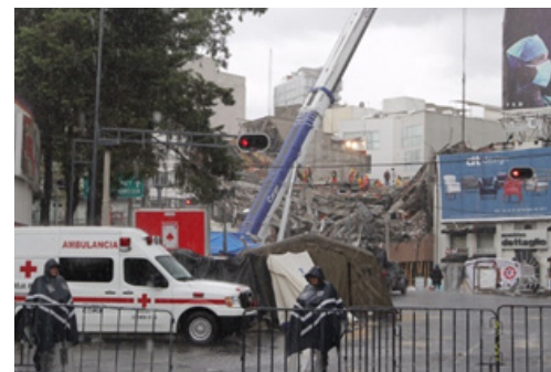
FIGURA 9: Colisión del edificio Álvaro Obregón 286, 2017, Ciudad de México.
