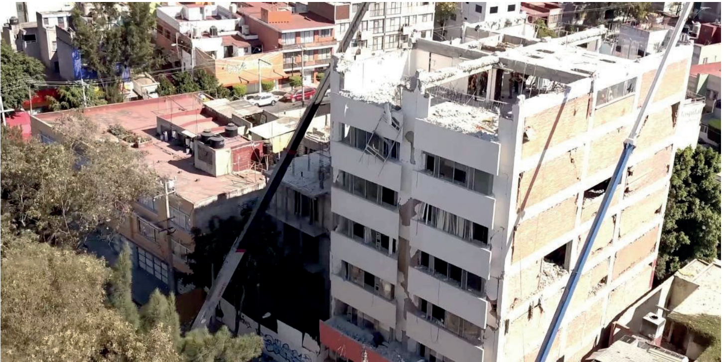
VISTA AÉREA DEL CONJUNTO DE TRES TORRES EN EL PREDIO ESCOCIA 29, GRÚAS DE APOYO EN EL SITIO.
