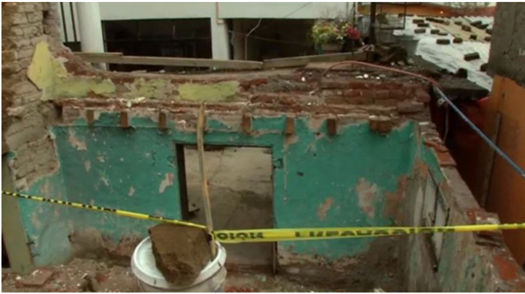
FIGURA 25: Derrumbes en viviendas de la colonia Santa Rosa en la delegación Álvaro Obregón, 2017, Ciudad de México.
