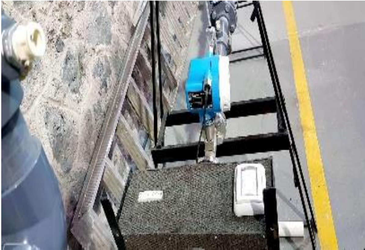
Fig. 13 Tablero de control del analizador Vortex, fuente de poder y ventilador auxiliar.
