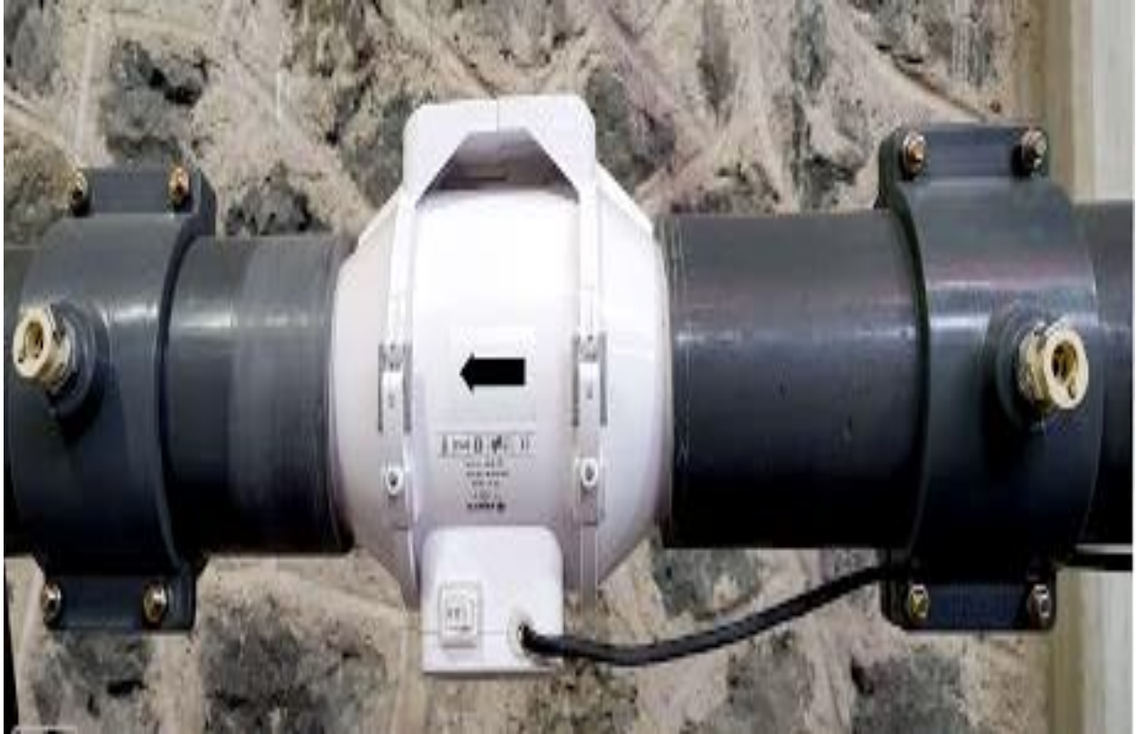
Fig12 a Ventilador auxiliar.
