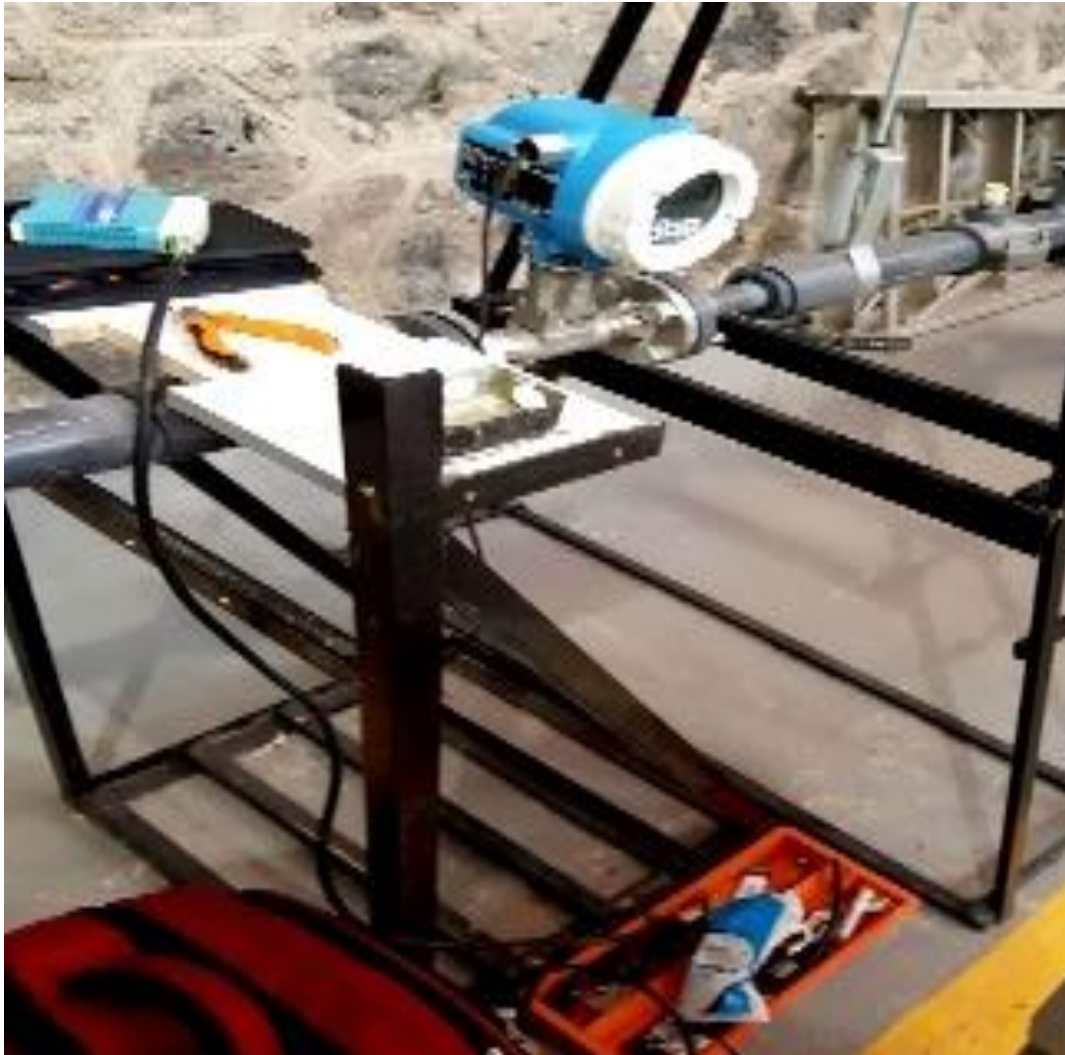
Fig. 8a Analizador de flujo Vortex se utilizara para observar el caudal que circula por este con las diferentes configuraciones en la tubería.
