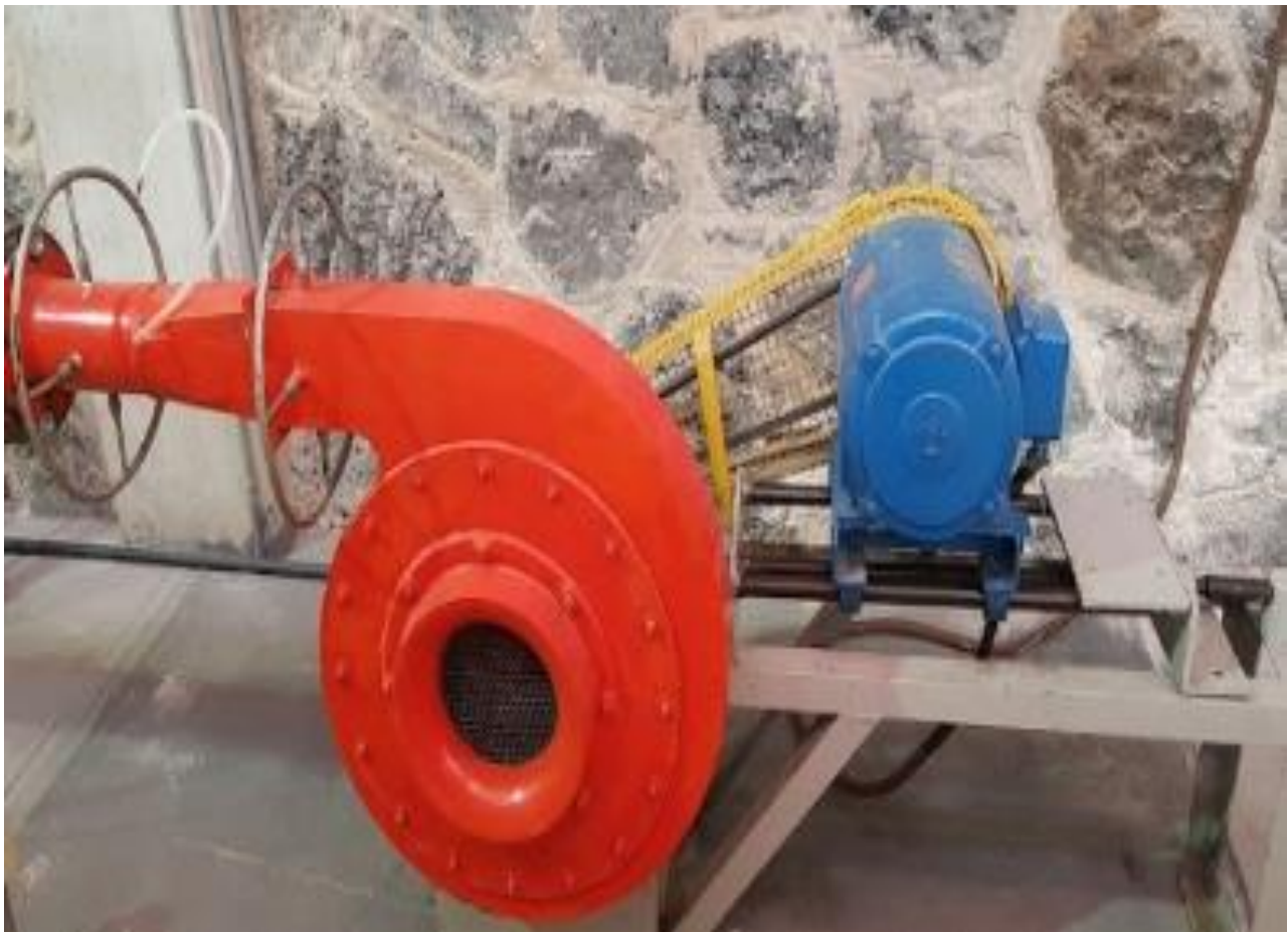
Fig. 1 Vista del turbo soplador naranja y motor electrico azul
