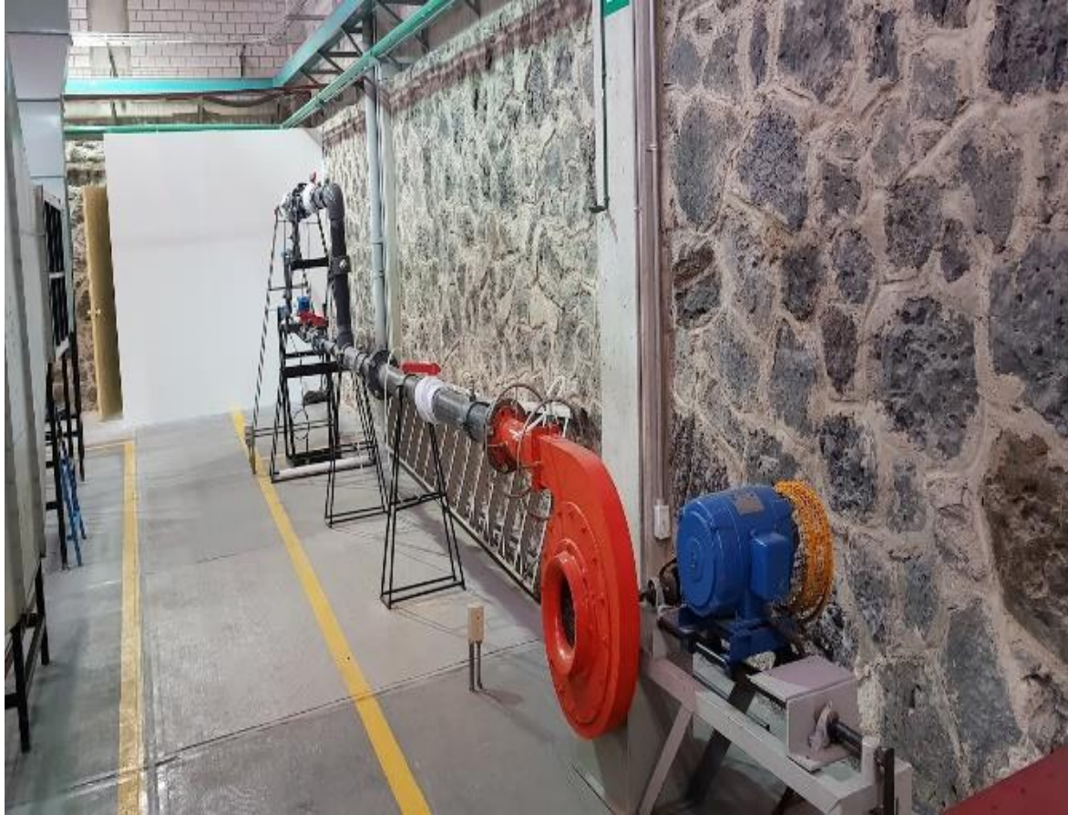
Fig.6 Se debe tener la precaución de no permitir acceso a ninguna persona del lado de las poleas del motor, (rejillas amarillas) aunque no esté en funcionamiento.
