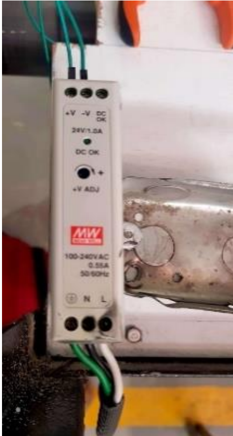
Fig.9b Fuente de poder del analizador de caudal Vortex.
