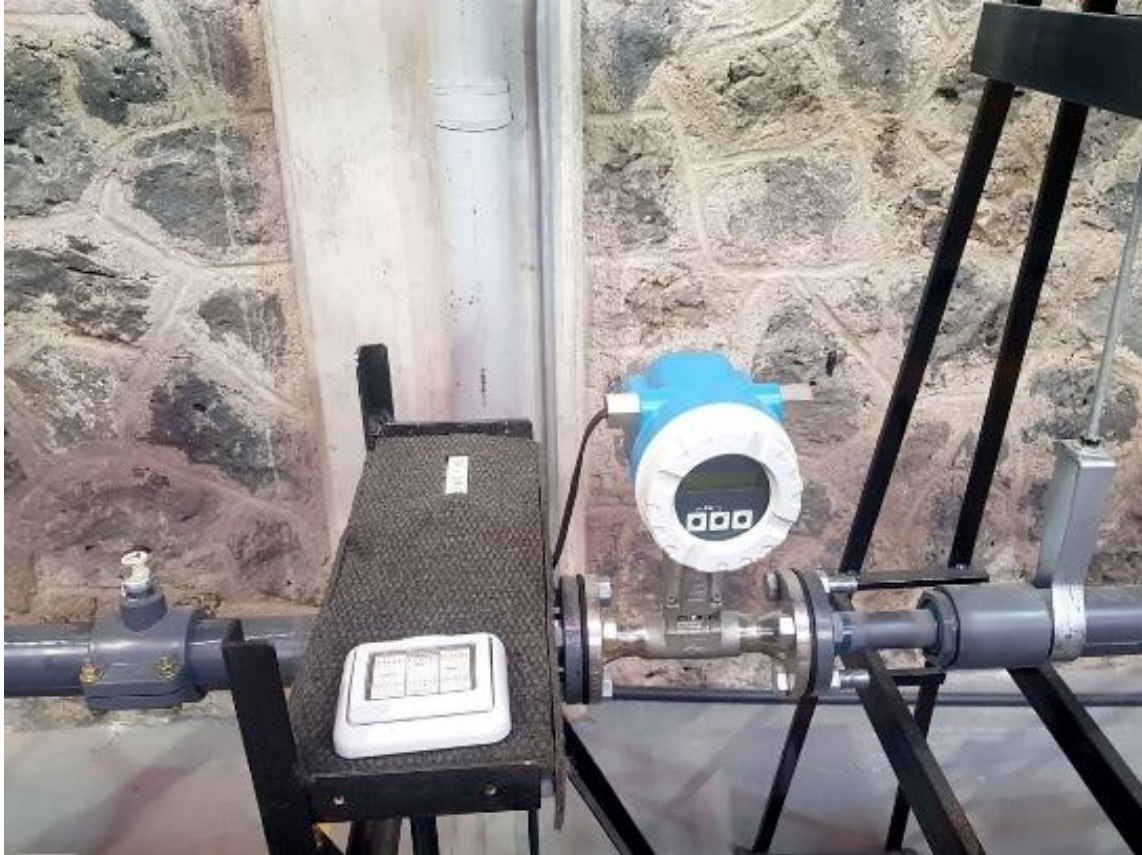
Fig 9d. Vista final del tablero de control del Analizador Vortex, tablero de control, e interruptores.
