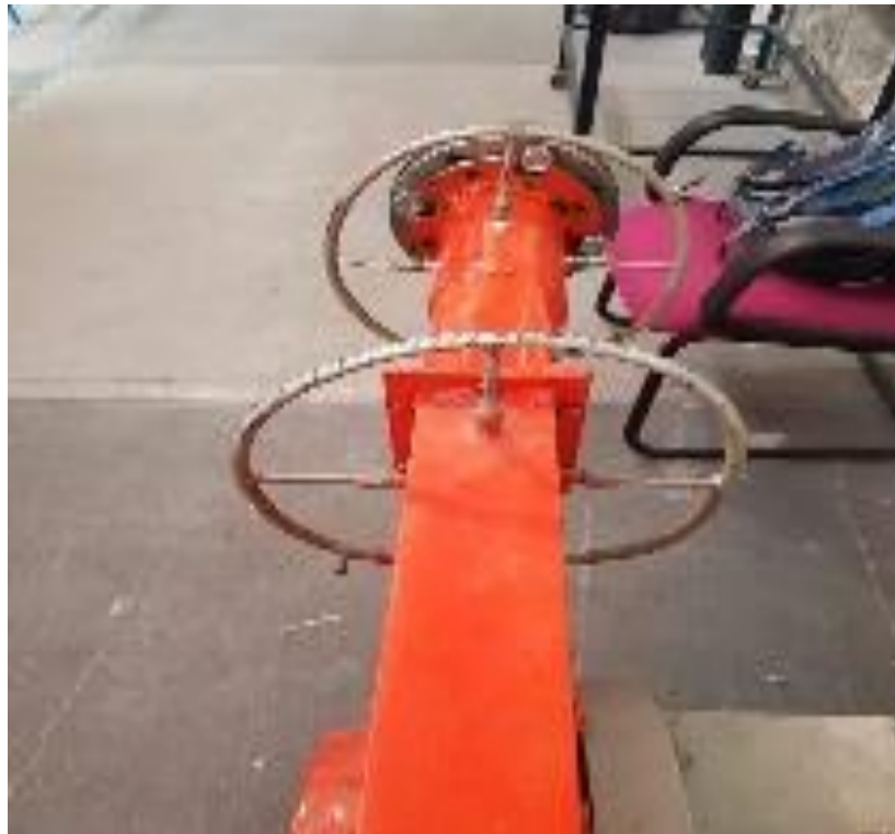
Fig. 3 Vista posterior del acoplamiento al turbosoplador y arillos de cobre
