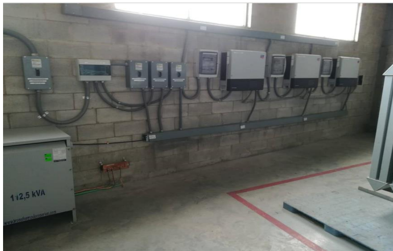
Figura 3.4 Instalación eléctrica dentro de la subestación
