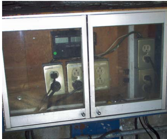
Figura 3.2 Reloj programable y contactos dentro de una caja protectora
