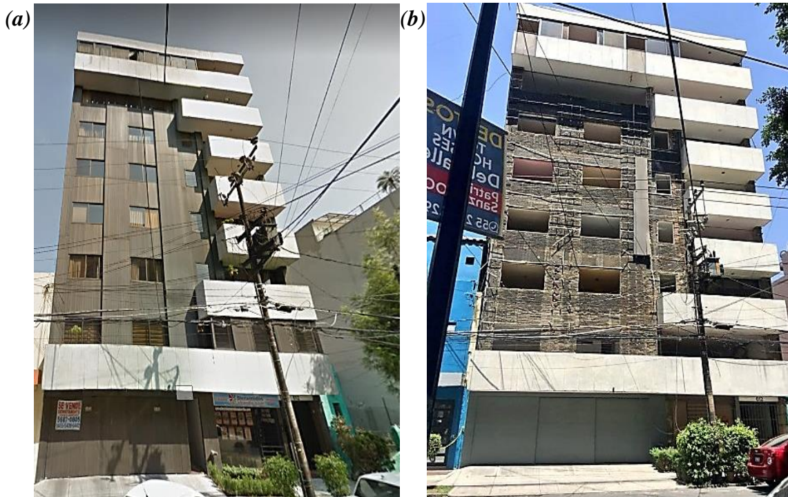
Figura A4. Edificio considerado DS 4 : (a) Vista exterior del edificio previo al sismo https://bit.ly/2Nb9AP9 , (b) Vista del edificio posterior al sismo, (c) Daños en muros laterales exteriores (d) Detalles de daños observados en la planta baja del edificio, (e) Detalle de los severos daños en elementos estructurales, muros y columnas, (f) Acero de refuerzo expuesto en columnas, (g) Severos daños en muros, vista del cubo interior de iluminación, (h) Daños en muros interiores del edificio, (i) Daños en elementos no estructurales en la planta baja, (j) Fisuras en muros interiores mayores a 5 mm de abertura, y (k) Condiciones de las instalaciones del edificio.
