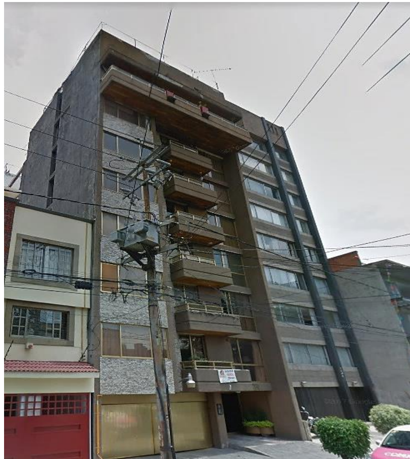
Figura 3.7. DS_1 - Edificio BJU32_2017 no presentó daño, a excepción de fisuras en los muros de algunos niveles (imagen obtenida de https://bit.ly/36ES7Y1 )
