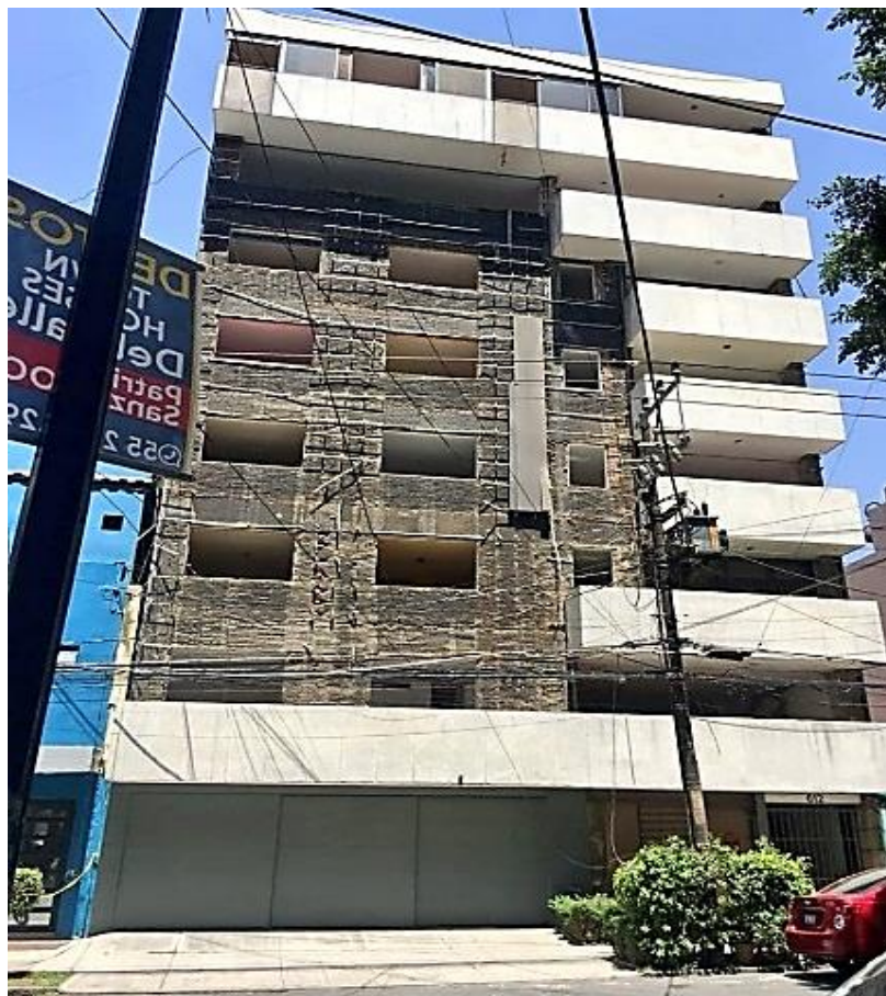
Figura 3.10. DS_4 - BJU34_2017 tuvo daños tan severos que ameritó su demolición (imagen obtenida de https://bit.ly/2Nb9AP9 )
