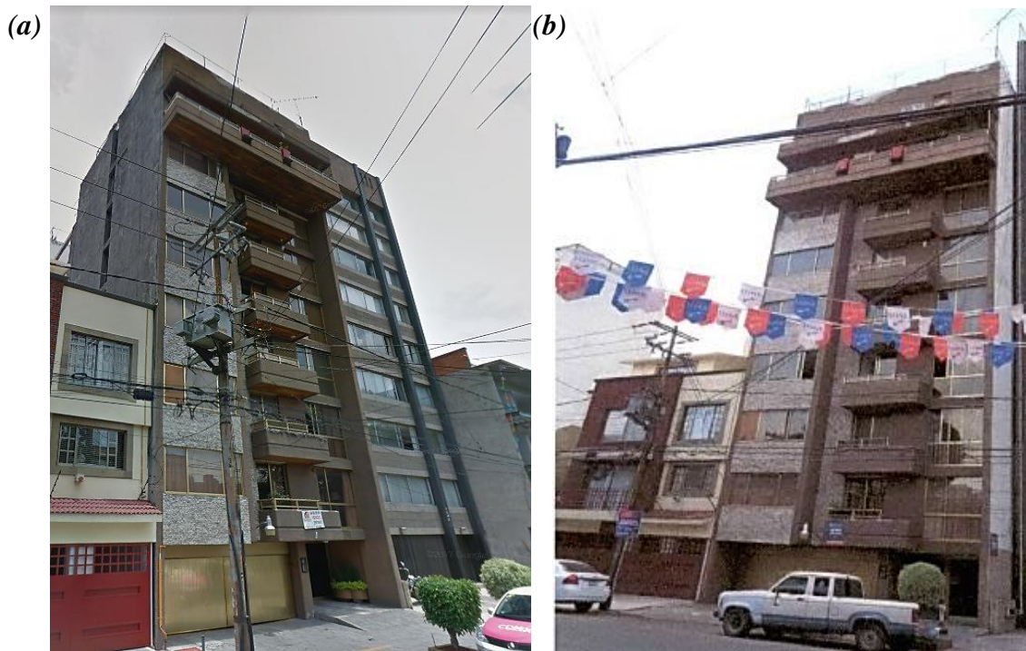
Figura A1. Edificio considerado DS 1 : (a) Vista exterior del edificio previo al sismo https://bit.ly/36ES7Y1 , (b) Vista del edificio posterior al sismo, (c) Vista del cubo del edificio con leves fisuras en vanos (d) Detalles de daños observados en cubo interior del edificio, (e) Daños en muros de fachada, encontrándose en proceso de reparación los daños, (f) Ligera separación del muro perimetral y el elemento del sistema estructural del edificio, vista en el primer nivel del edificio, (g) Leves fisuras en muros del cuarto de servicio en azotea y (h) Separación de la losa maciza y el pretil.
