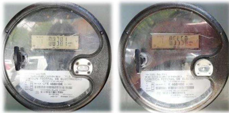
Ilustración 3. Medidor eléctrico del inmueble
