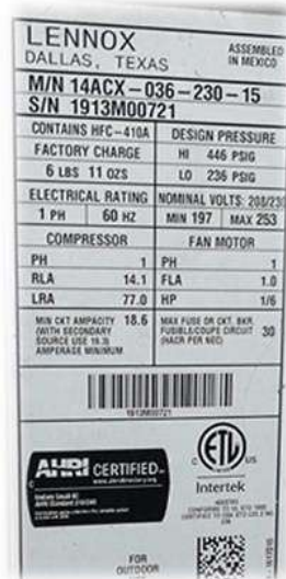
Ilustración 18. Datos de placa del Equipo de Aire Acondicionado número 3
