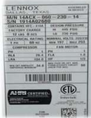
Ilustración 15. Datos de placa del equipo de aire acondicionado número 2
