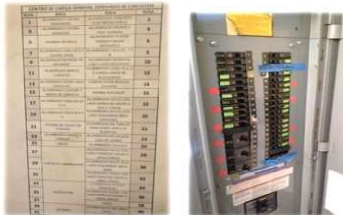
Ilustración 27. Tablero de Iluminación
