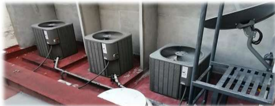
Ilustración 4. Equipos de Aire Acondicionado
