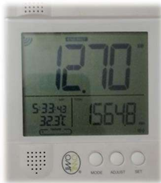
Ilustración 29. Monitor de energía, medición iluminación (Tablero C)
