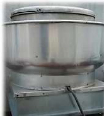
Ilustración 10. Campana de extracción de la parrilla
