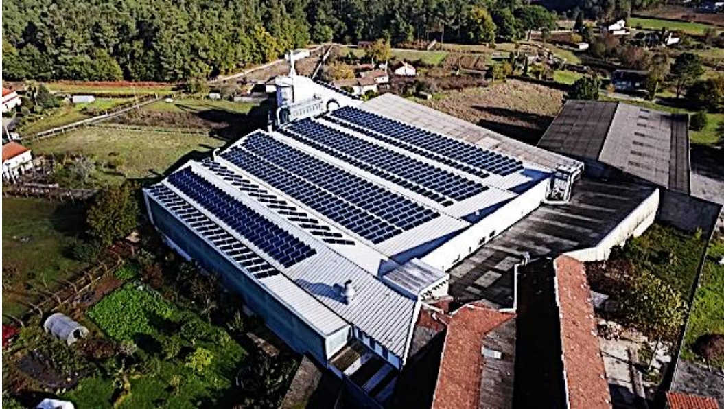
Ilustración 8. Instalación de energía solar fotovoltaica para autoconsumo en Muebles Santos Camporrapado, España [edfsolar.es].
