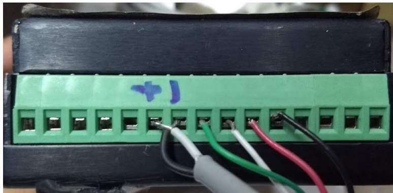
Figura 5.2.23 Conexiones de los cables auxiliares con el convertidor analógico
