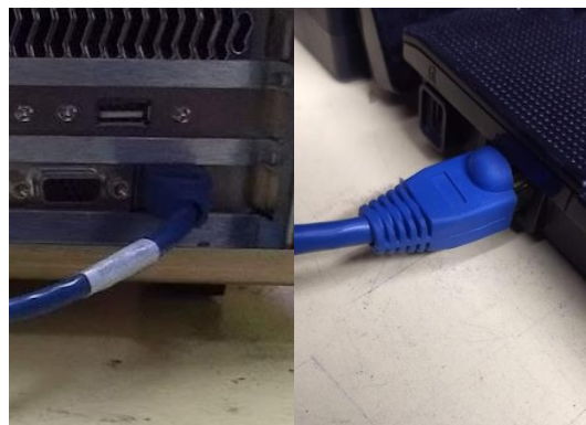
Figura 5.2.44 Conexión entre los equipos con un cable ethernet
