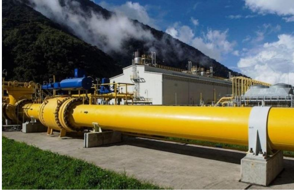
Figura 3.3 Ducto de gas expuesto a cambios bruscos de temperatura por radiación solar, lluvias, nevadas y alguna posible flama
