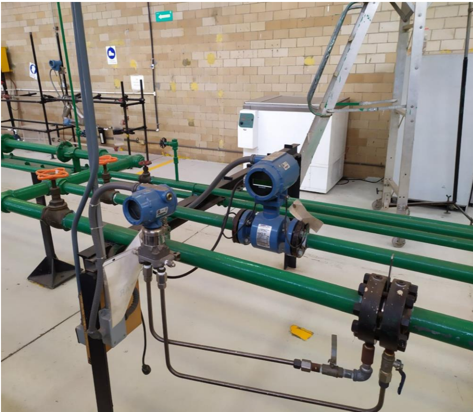
Figura 3.1 Sistema hidráulico del laboratorio de la Facultad de Química.
