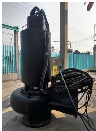
Figura 2-7. Bomba instalada en la planta de bombeo
