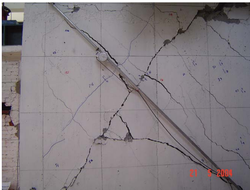
Figura 3.19. Agrietamiento en la diagonal principal en el otro sentido
