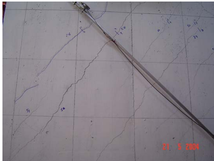
Figura 3.17. Agrietamiento en la diagonal principal en muro MCC50M
