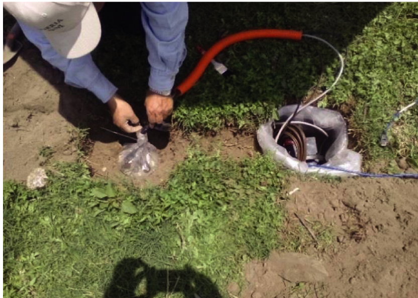
Figura 2.9 Instalación de las estaciones temporales de la Red del Instituto de Ingeniería (IINGEN).
