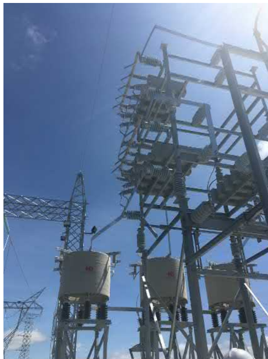
Figura 4.8: Filtros instalados en el CEV de la SE Escárcega en 400 kV [1].
