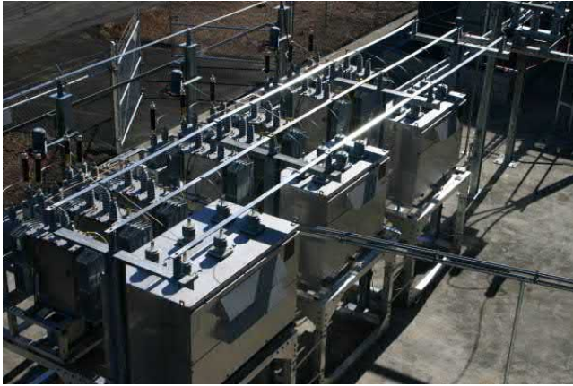
Figura 4.6: TSC instalado en el CEV de la SE Escárcega en 400 kV [1].
