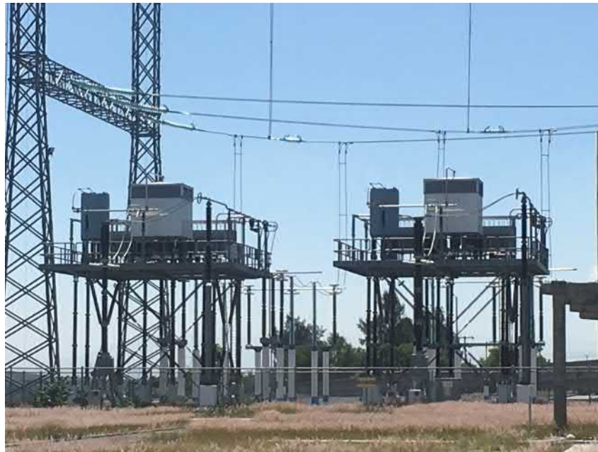
Figura 2.15: Capacitores serie instalados en la subestación Tecali [9].
