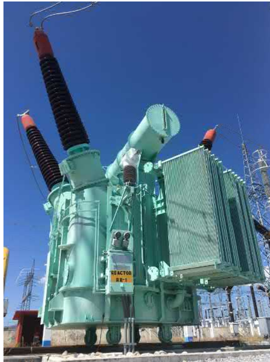
Figura 2.14: Reactor trifásico instalado en la subestación Tecali [9].
