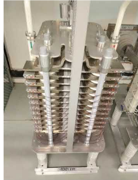
Figura 4.5: Sistema de tiristores del TCR [1].
