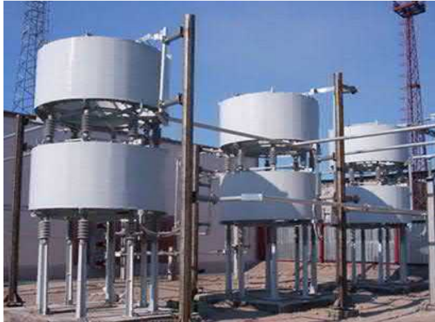
Figura 4.4: TCR instalado en el CEV de la SE Escárcega en 400 kV [1].
