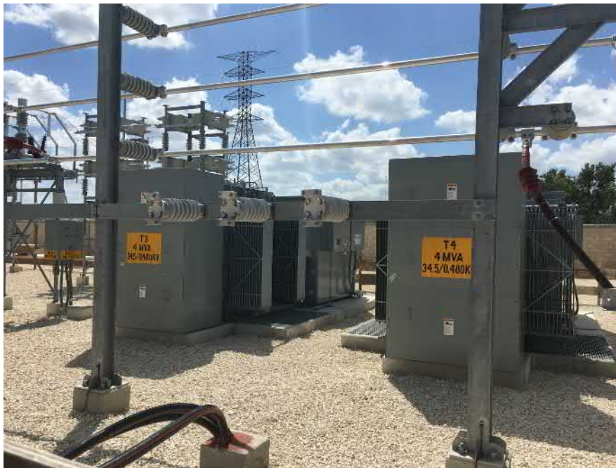
Figura 2.16: STATCOMs instalados en un Parque Eólico en Yucatán [9].
