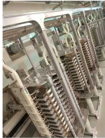
Figura 4.7: Sistema de tiristores del TCR.
