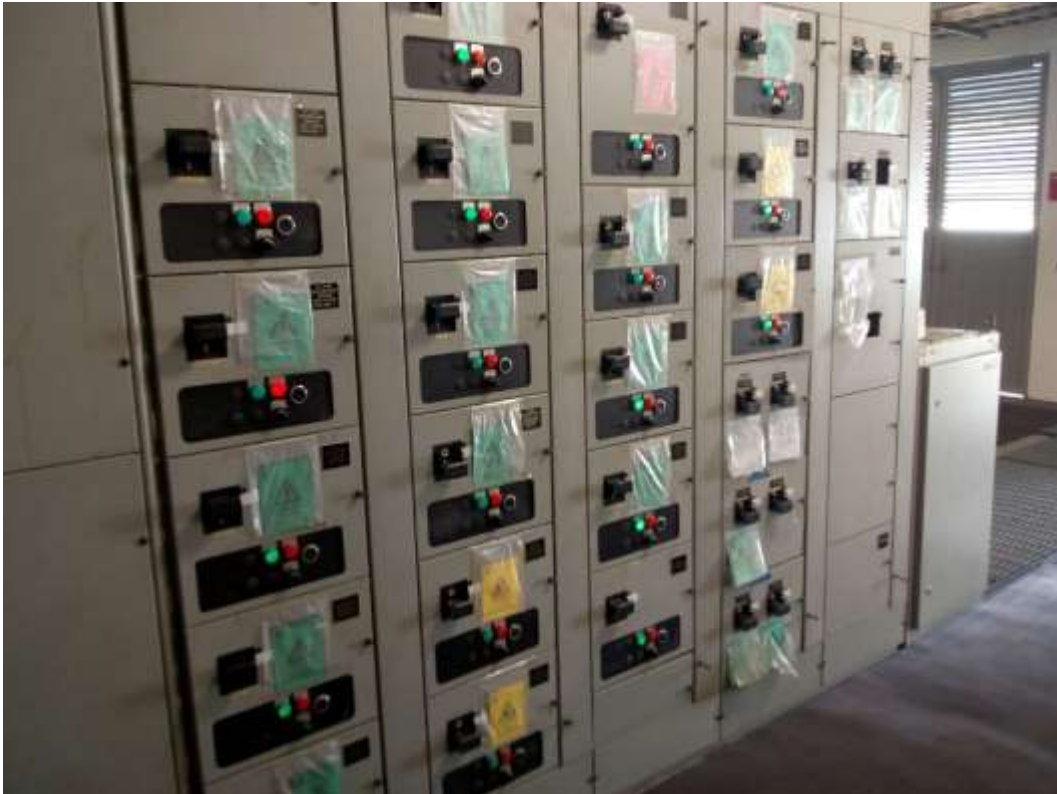
Figura 35. Cuarto de control
