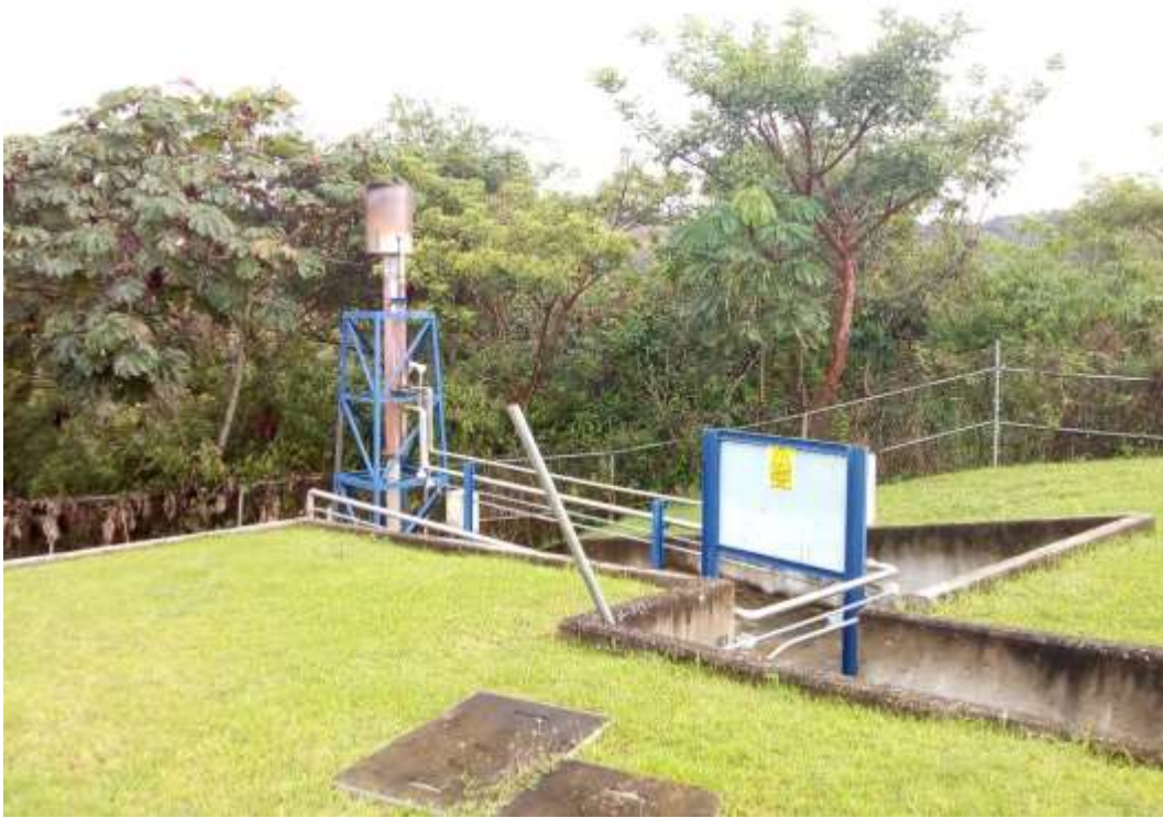
Figura 32. Quemador de biogás
