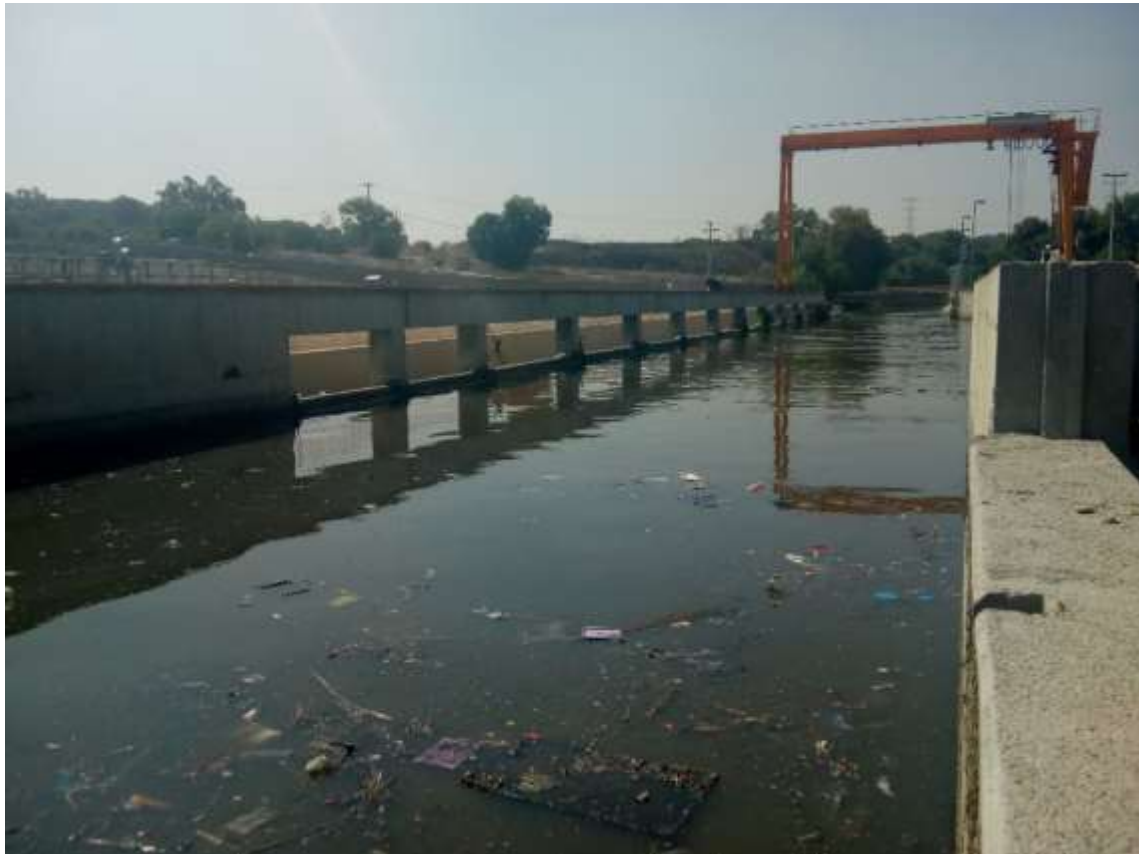
Figura 36. Canal de aguas residuales afluentes a la PTAR
