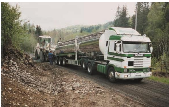
Ilustración 39 Una prueba del rendimiento de la máquina WR 2500: en esta obra en Noruega, el abastecimiento de ligante de este carrotanque fue suficiente para reciclar 2,500 m 2 en poco menos de 2 horas. Fuente Betún Espumado de Wirtgen.
