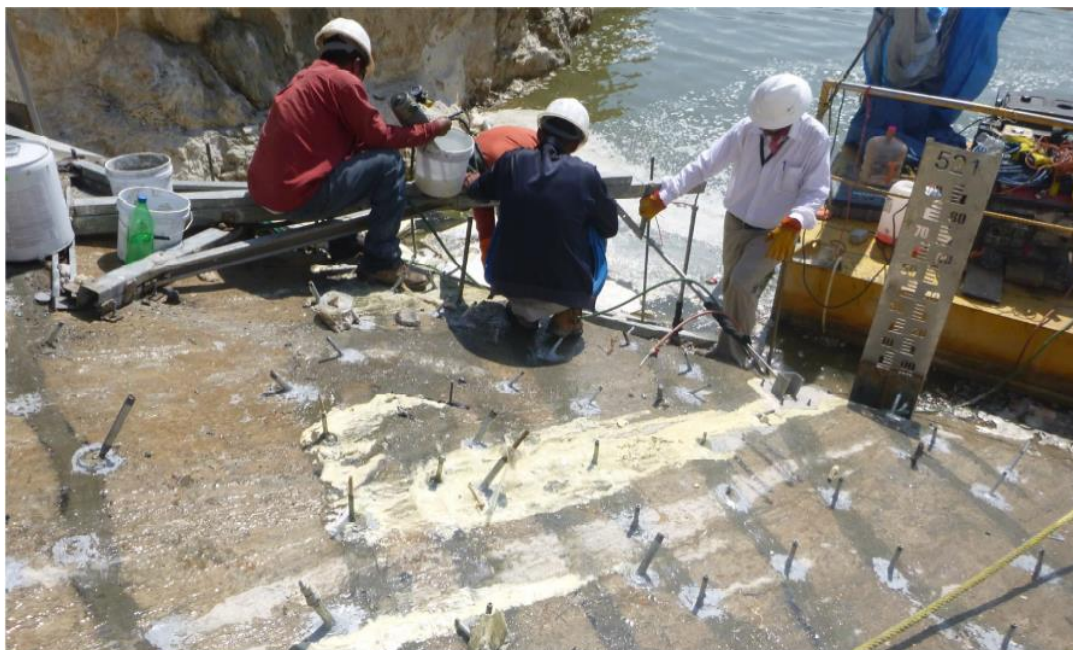
Figura 53. Reparación de fracturas localizadas en la losa del plinto, vista desde la berma +522, (CFE, agosto 2015).
