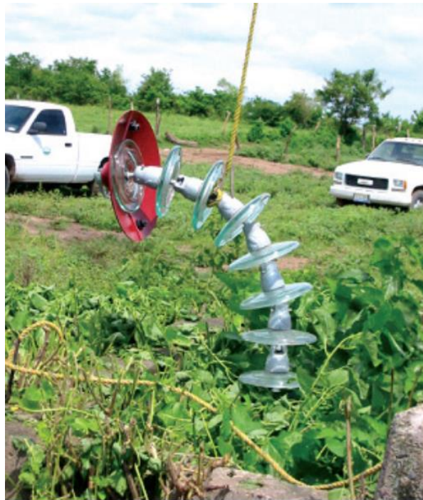
Figura 3.12 Sombrero chino colocado en cadena de aisladores de vidrio
