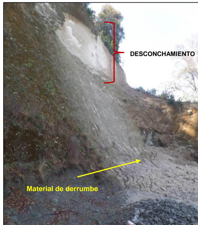
Fotografía 5.3. En la parte superior se observa el desconchamiento ocurrido en dicho miembro en un corte de 60° ~ 70° de inclinación. En la parte inferior se indica con flecha el material de derrumbe deslavado por las lluvias. Una situación similar se podría esperar en el talud izquierdo, si no se toman las medidas de protección o estabilización pertinentes.
