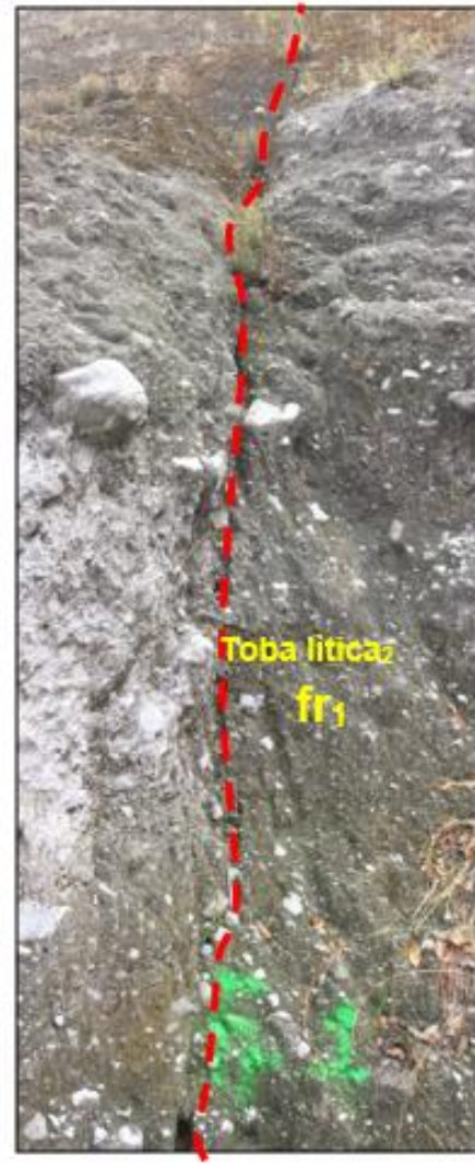
Fotografía 4.33. Fractura ( fr_1 ) parcialmente abierta y rellena por limo.
