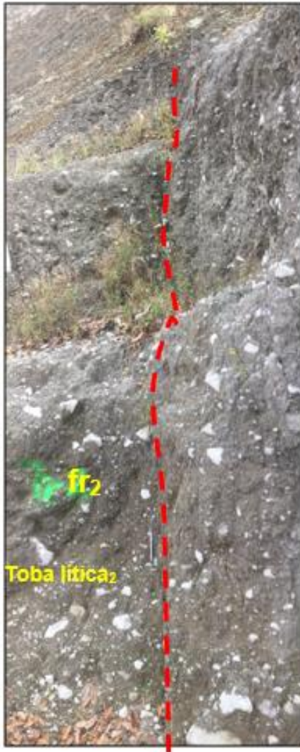
Fotografía 4.32. Fractura ( fr_2 ) nótese que se encuentra abierta y rellena por limo
