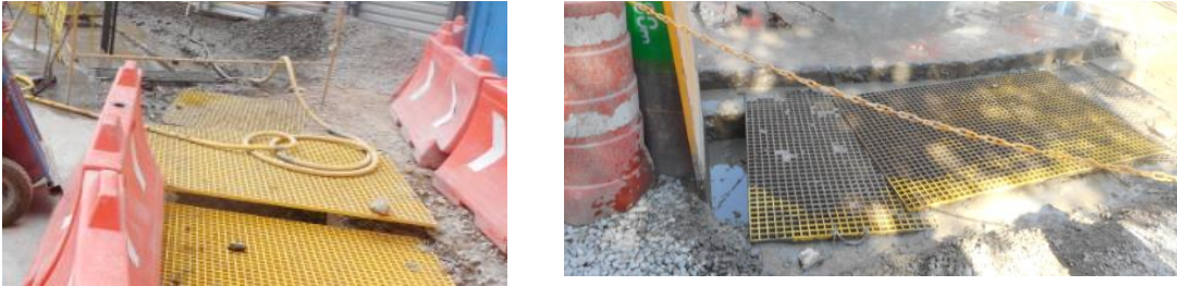
Ilustración 149 Rejillas para cubrir una zanja. 7
