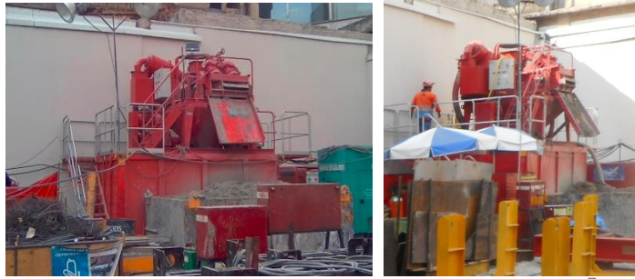
Ilustración 39 Desarenador de lodos bentoníticos. 7
