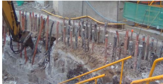
Ilustración 97 Contaminación de lodos de la parte superior del muro. 7
