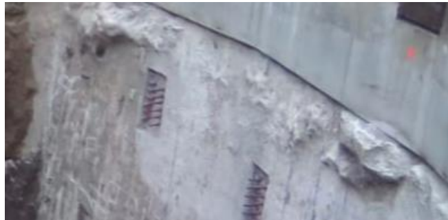
Ilustración 172 Imperfecciones en el muro Milán. 7
